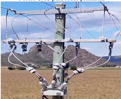
Reconector automático - Recloser
