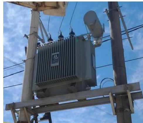
Subestación de distribución
