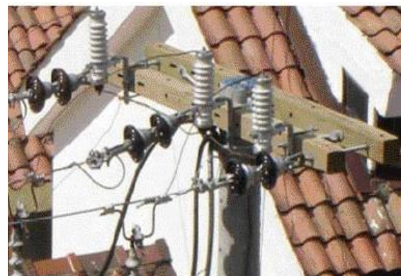
Crucetas y Pararrayos
