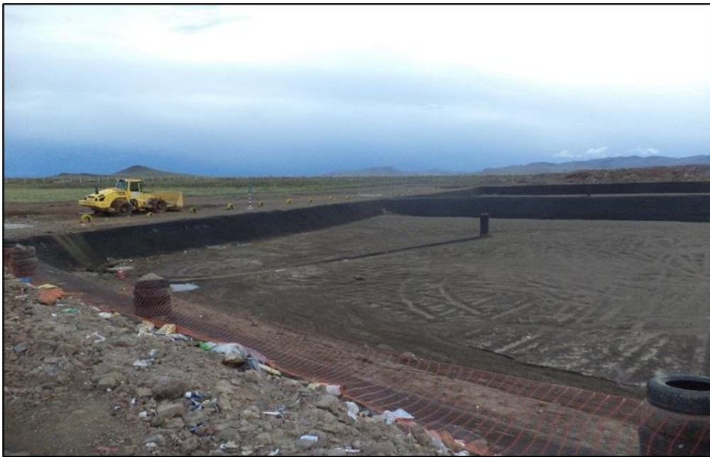
Figura 68. Impermeabilización del Relleno Sanitario de Itapalluni
