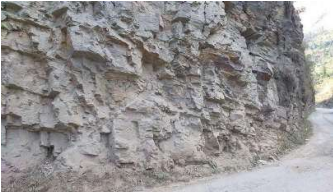
FOTO 04: Estación geomecánica 03 con dirección NS, afloramientos de roca metarenisca de la Formación Sandia, al terminar el talud se observa aperturas > 5\text{mm} .
