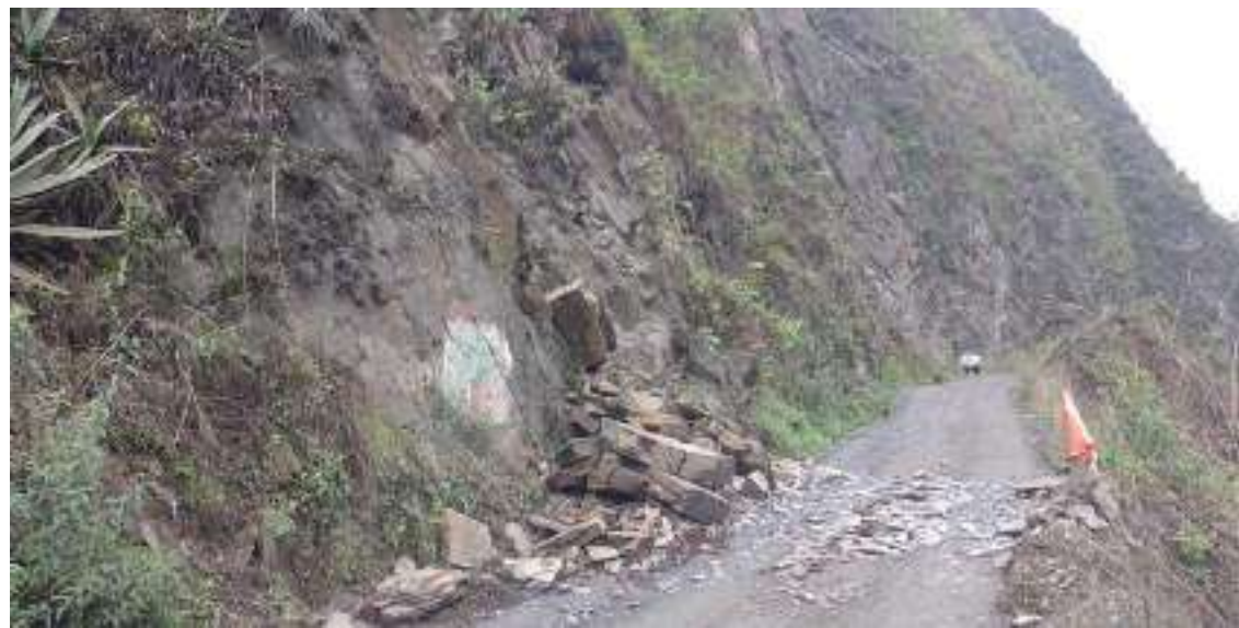
FOTO 10: Desprendimiento de rocas en el tramo en estudio.
