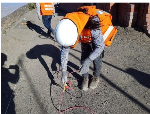
Control de conexión estable de conectores Fuente, Autor 2020
