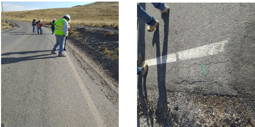
Figura 11: Se observa al lado derecho e izquierdo la evaluación de la falla de la carpeta asfáltica en la curva Tramo III.
