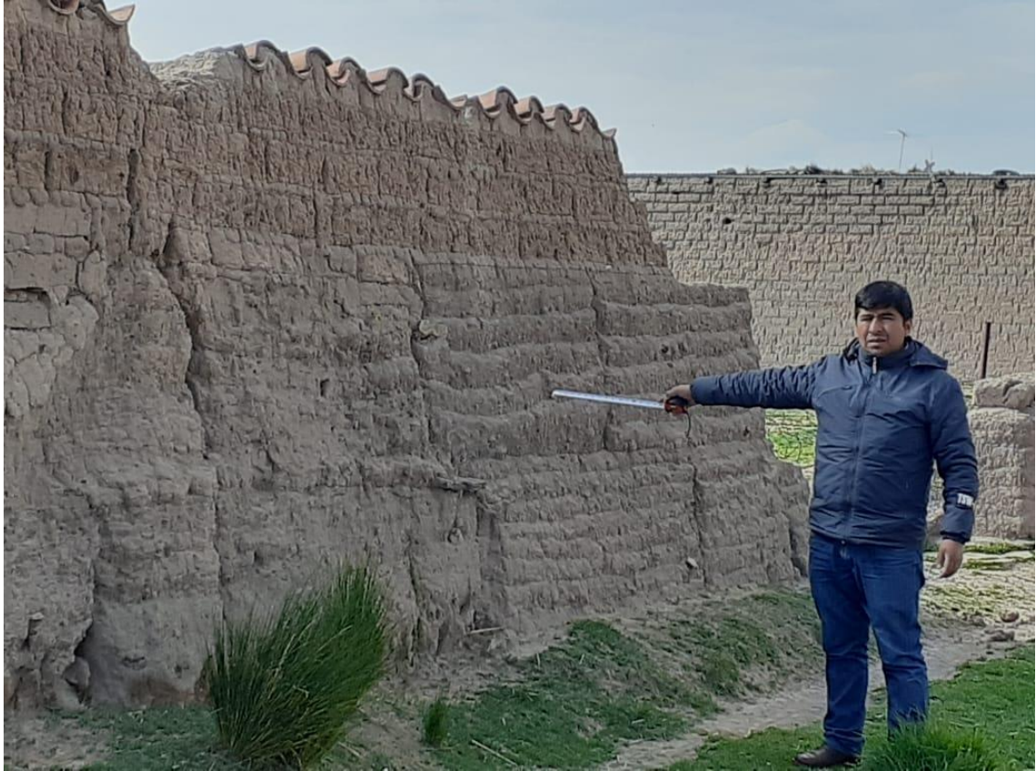
FIGURA N°02: EVALUACIÓN DE FALLAS EN VIVIENDAS DE ADOBE.
