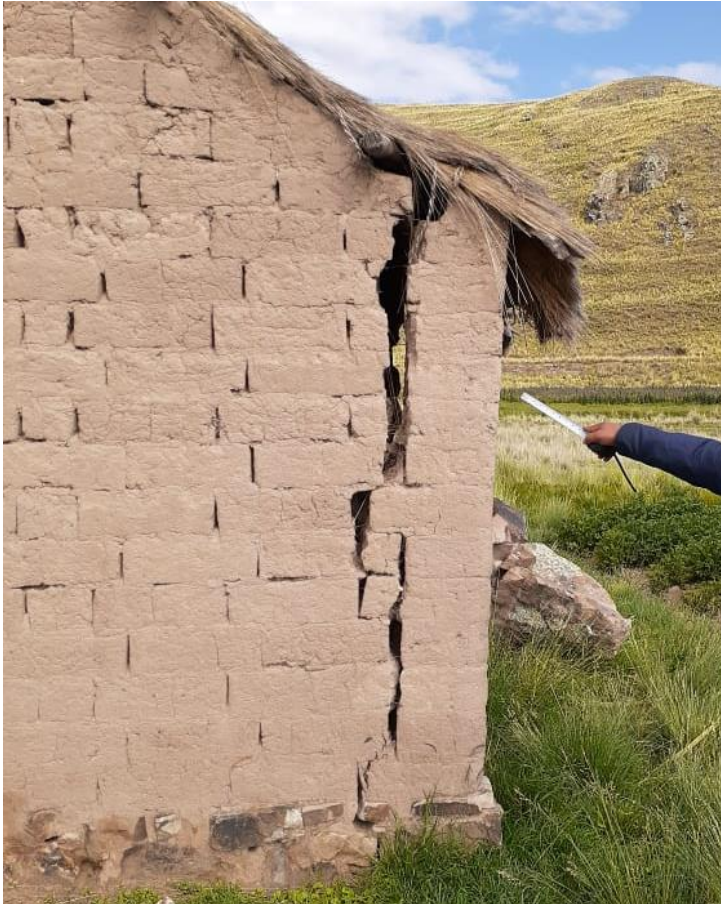
FIGURA N°03: EVALUACIÓN DE FALLAS EN VIVIENDAS DE ADOBE.
