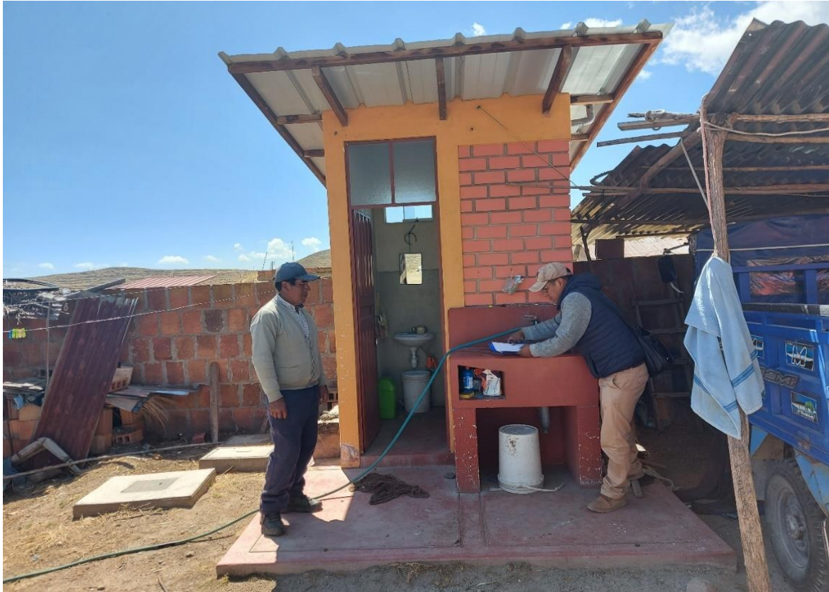
Figura 13. Unidad básica de saneamiento
