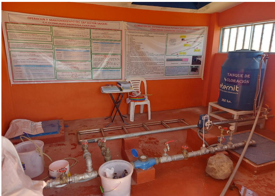
Figura 11. Ambiente del sistema de tratamiento
