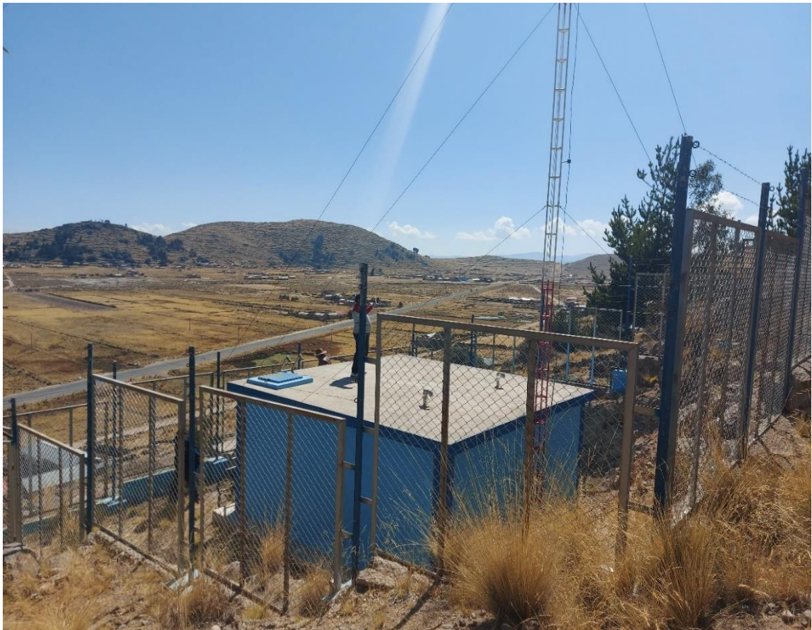
Figura 12. Reservorio para sistema de distribución
