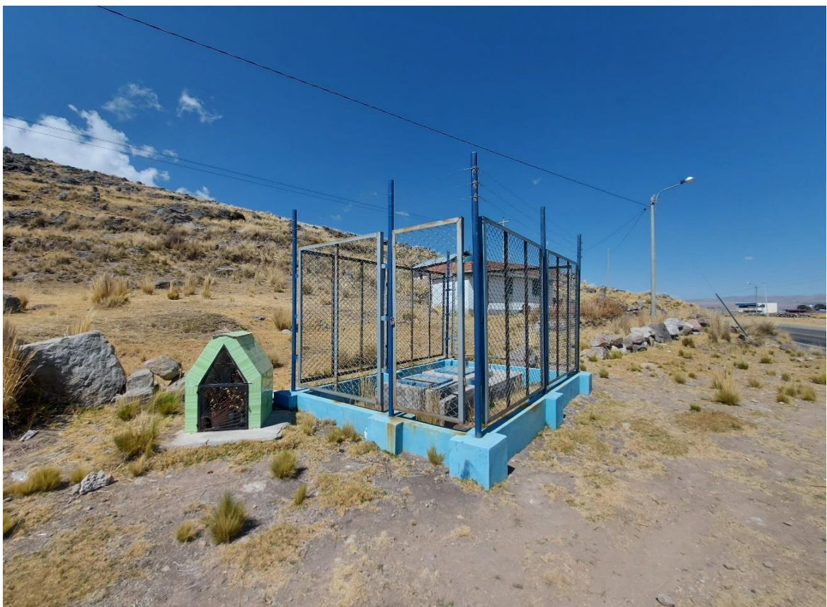
Figura 7. Sistema de captación de manantial
