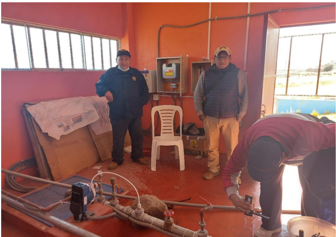
Figura 10. Ambiente de la administración y control de bombeo
