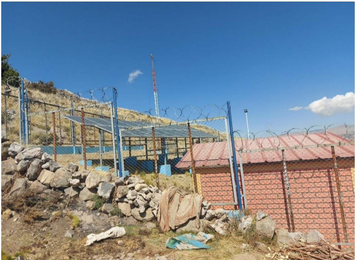
Figura 9. Sistema de bombeo con panel solar
