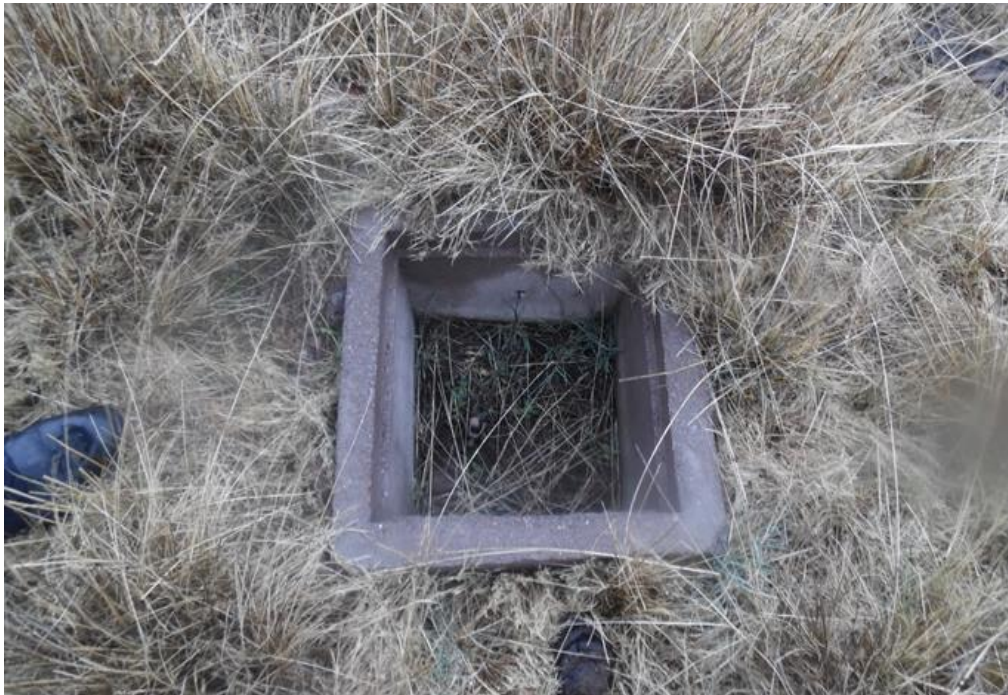
Figura N° 3.19: Puesta a tierra deficiente
