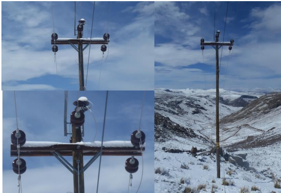
Figura N° 3.20: Aislador Porcelana expuesto a la Nieve.
