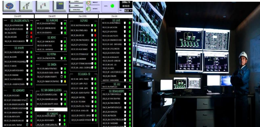
Figura N° 3.23: Centro Control Electro Puno
