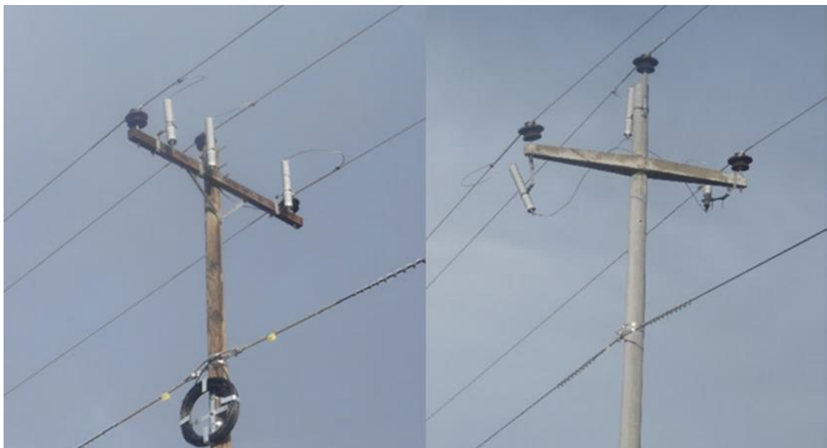
Figura N° 3.17: Pararrayo Porcelana instalado en Línea Primaria.
