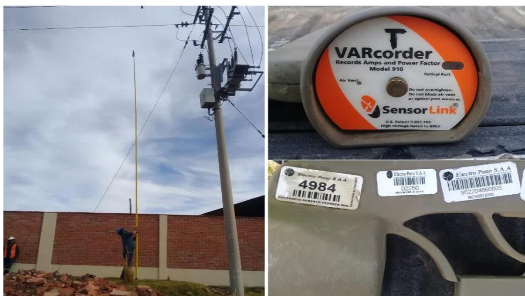
Figura N° 3.24: Medición Corriente y CosØ con VARCORDER
