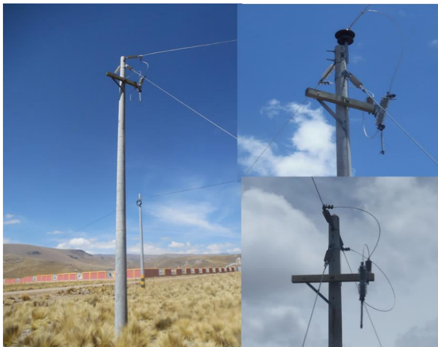
Figura N° 3.18: Seccionador CUT OUT con Portafusible caído
