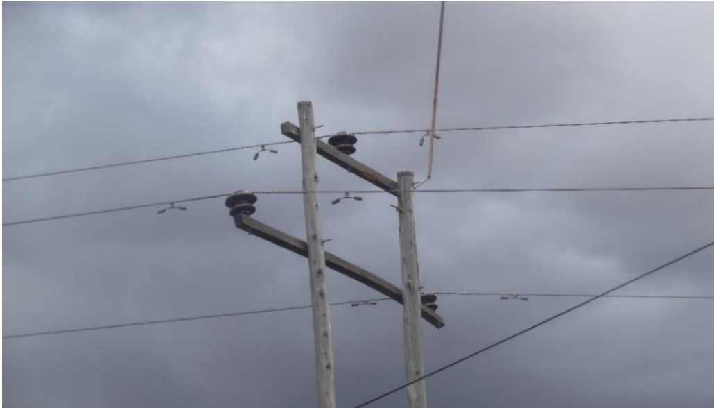
Figura N° 3.14: Cruceta de Madera a Punto de Romperse Elaboración Propia.
