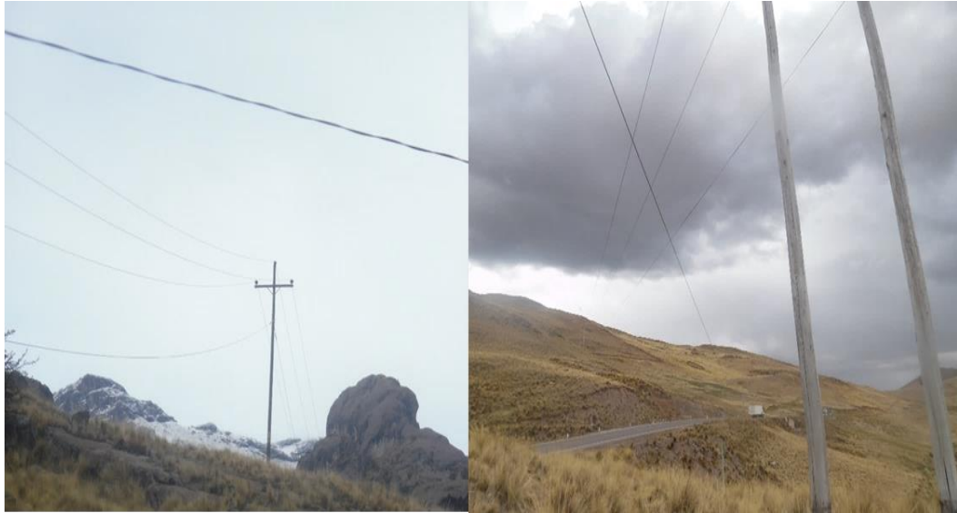
Figura N° 3.15: Línea Primaria con vanos muy largos Elaboración Propia.
