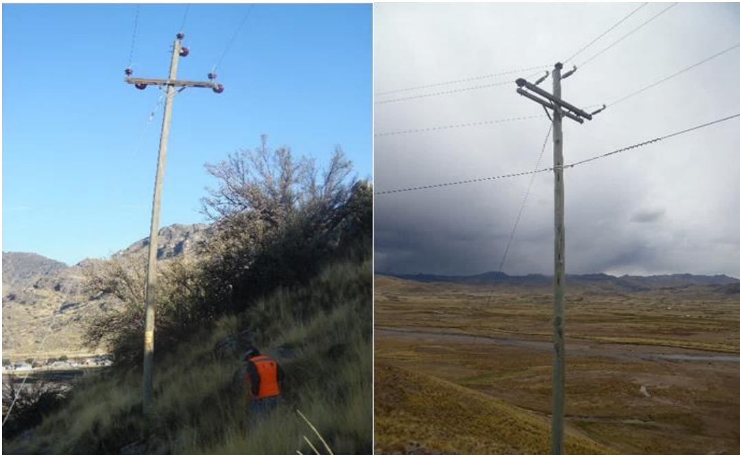
Figura N° 3.11: Poste de Madera con Deformación Elaboración Propia.
