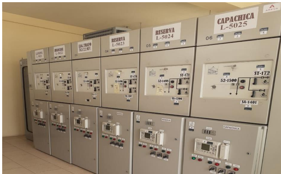
Figura N° 3.22: Celdas de Salidas en 22.9kV de la SS.EE. Taparachi
