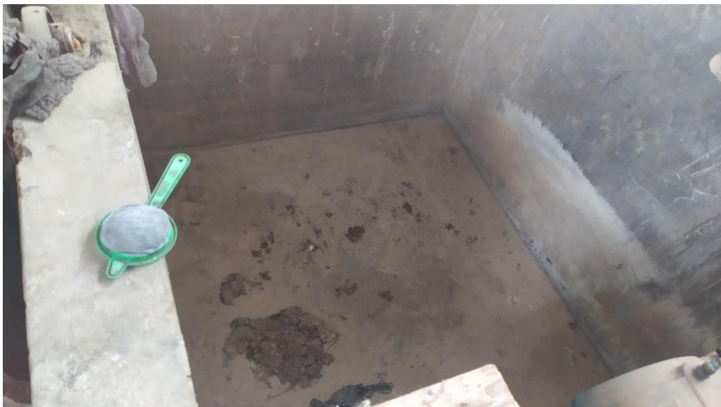
Peligro biológico en la planta
