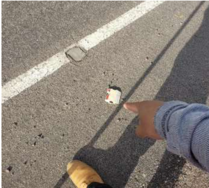
DETERIORAMIENTO DE TACHAS RETRORREFLECTIVAS
