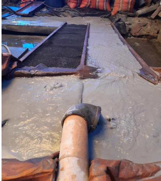
Figura 15. Canaletas gemelas con alfombra
