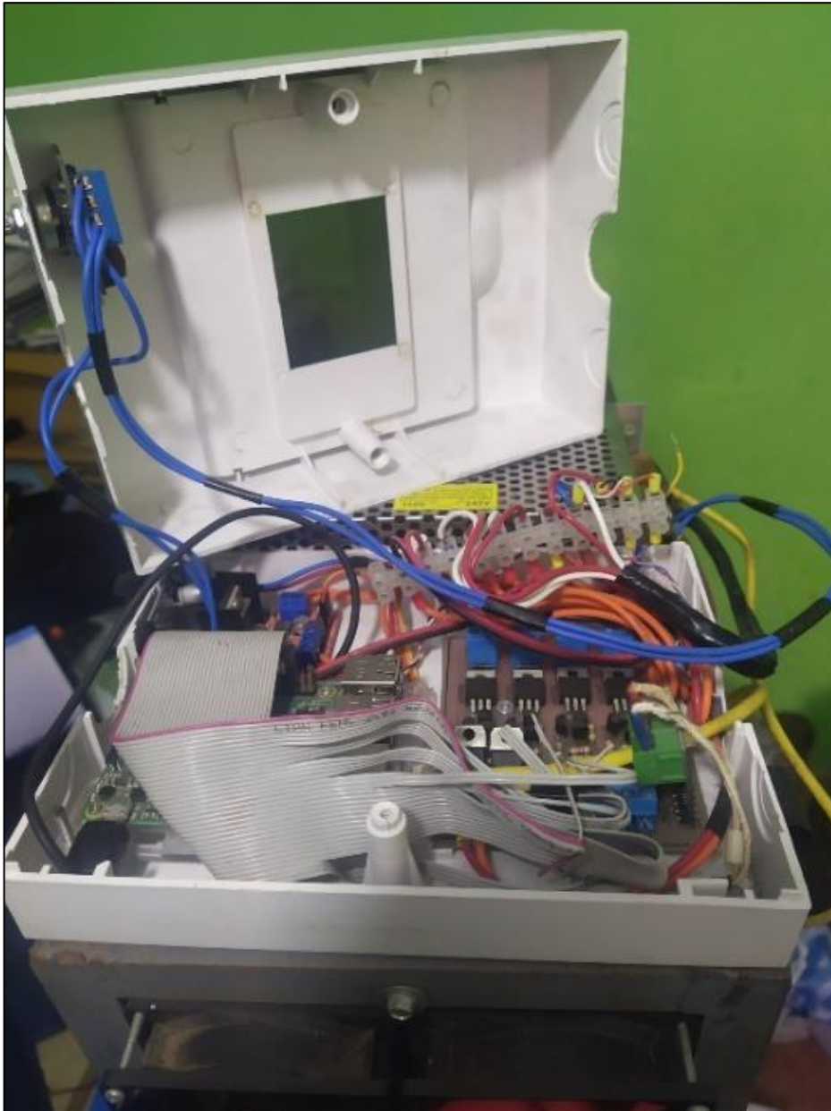
Figura 29: Caja que contiene los dispositivos de control
