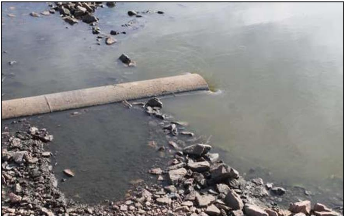
Figura N° 9: Conexiones clandestinas aguas residuales
