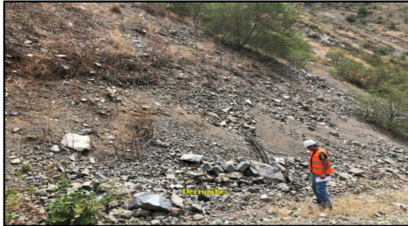
Figura 48. Vista del talud de la margen izquierda, presentando derrumbes de rocas.
