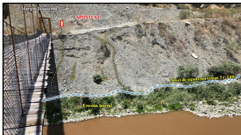
Figura 49. Vista del talud inferior de la margen izquierda, susceptible a erosión.
