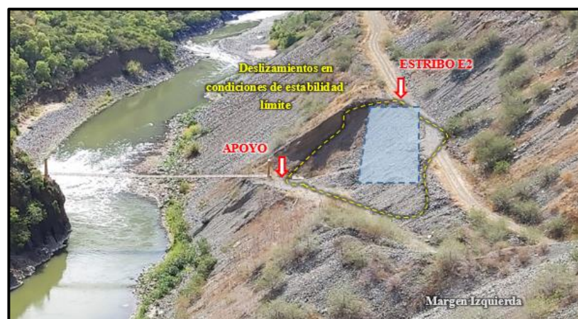
Figura 46. Vista del talud, deslizamientos en condiciones de estabilidad límite. Fuente: Elaboración propia.
