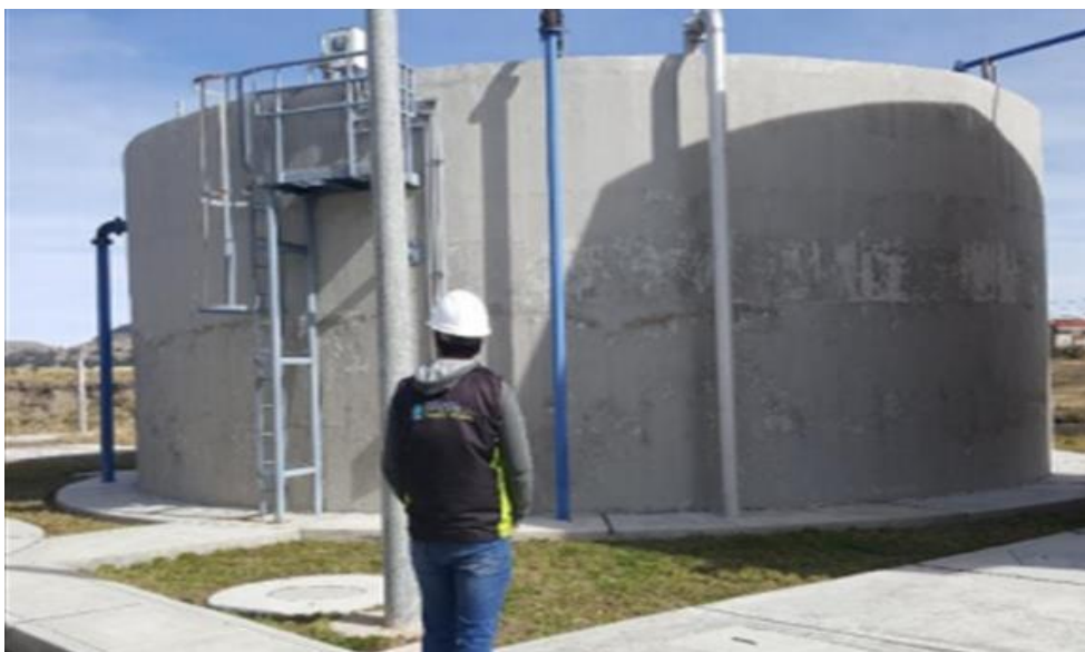
Figura 33. Digestor de lodos de la planta de tratamiento de aguas residuales de la provincia de Yunguyo.
