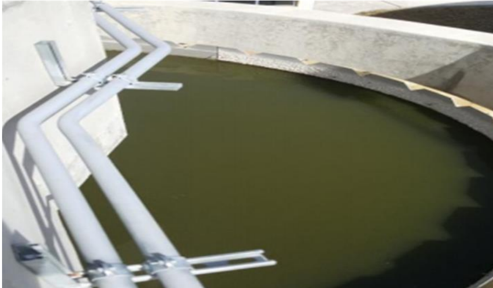
Figura 32. Espesador de lodos de la planta de tratamiento de aguas residuales de la provincia de Yunguyo
