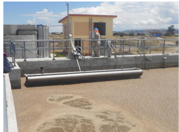
Decantador en proceso de aireación en el tanque ICEAS de la planta de tratamiento de aguas residuales de Yunguyo
