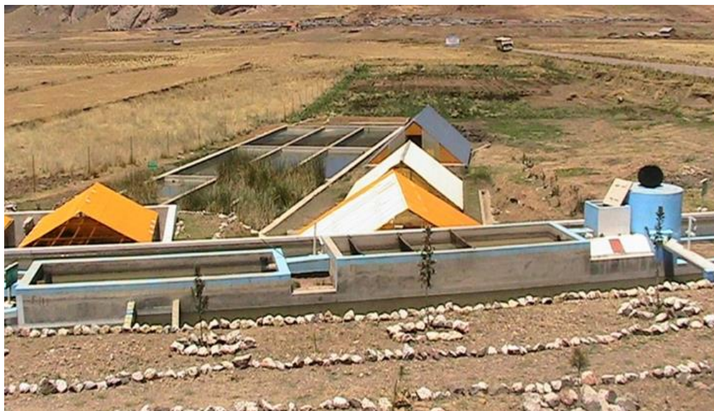
Figura 21. Planta de tratamiento de aguas residuales de José Domingo Choquehuanca
