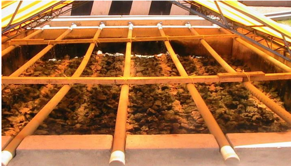
Figura 22. Vista del filtro percolador de la planta de tratamiento de aguas residuales de José Domingo Choquehuanca.
