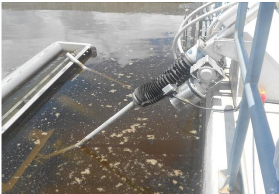
Decantador en el tanque ICEAS de la PTAR Yunguyo
