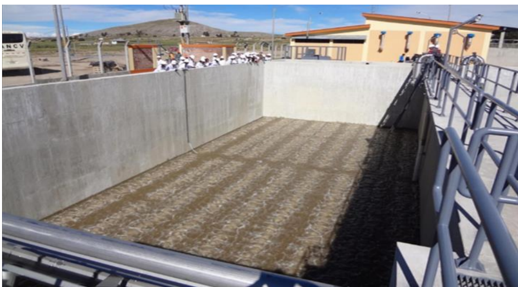
Figura 29. Tecnología de lodos activados de la planta de tratamiento de aguas residuales de la provincia de Yunguyo.
