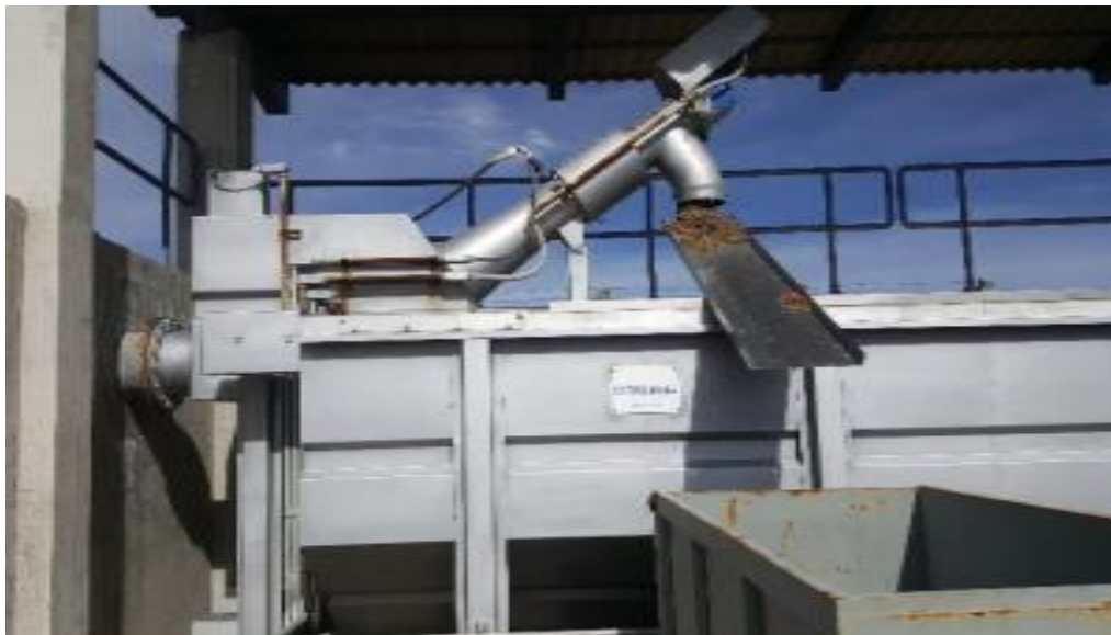
Figura 28. Sistema de cribas de la planta de tratamiento de aguas residuales de la provincia de Yunguyo
