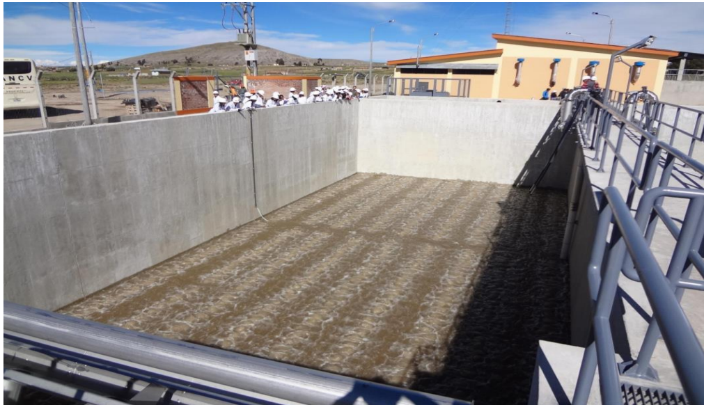
Figura 38. Tanques de aireación ICEAS
