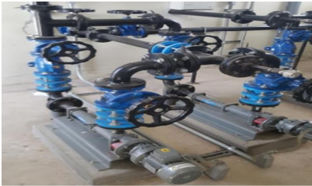
Figura 34. Bombas de tipo tornillo de la planta de tratamiento de aguas residuales de la provincia de Yunguyo
