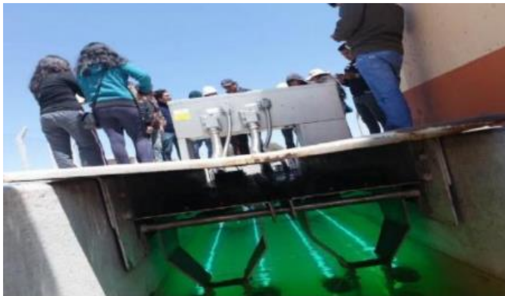
Figura 31. Desinfección de rayos UV de la planta de tratamiento de aguas residuales de la provincia de Yunguyo
