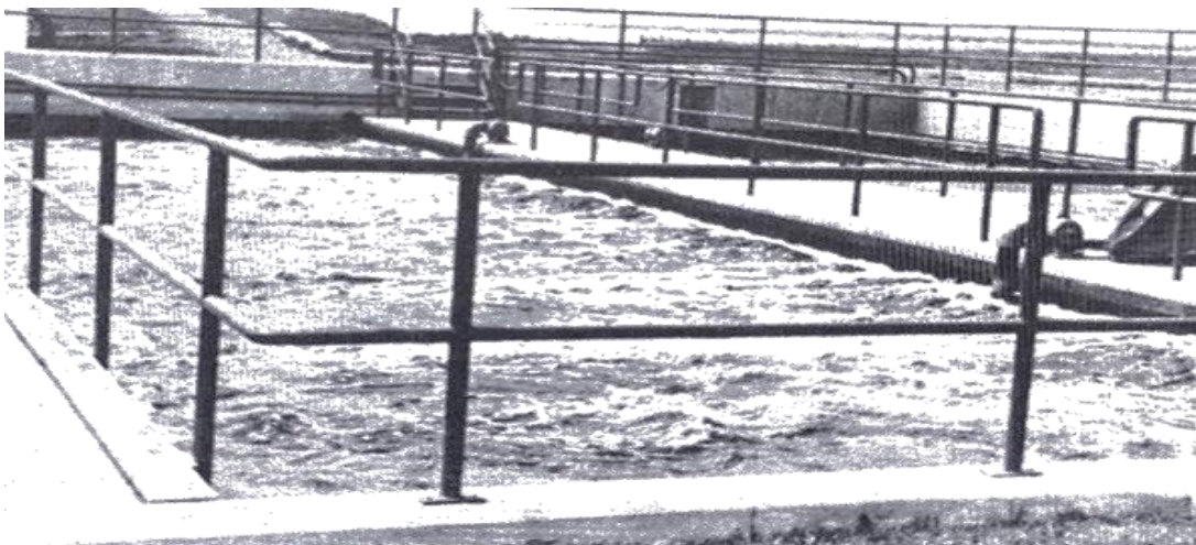
Figura 11. Estanque de aireación de una planta de depuración de aguas residuales de lodo activado.
