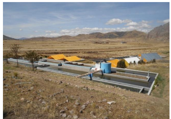
Vista de la planta de tratamiento de aguas residuales de José Domingo Choquehuanca
