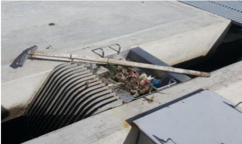
Figura 27. Cámara de rejas de la planta de tratamiento de aguas residuales de la provincia de Yunguyo
