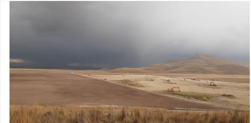
Foto 227. Trabajos de eliminación de material saturado y colocación de material de préstamo en plataforma – Diciembre 2020.
