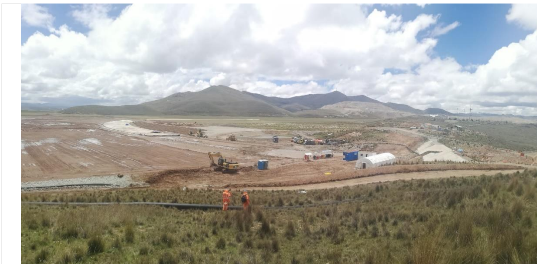
Foto 228. Trabajos de compactación de material en fondo de canal, conformación de material arcilla en plataforma - Enero.2021
