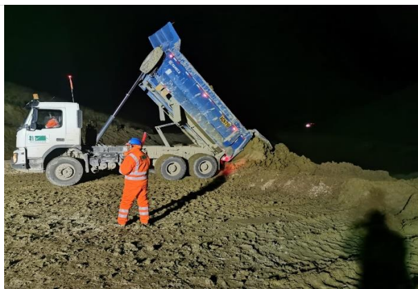
Foto 205. Empuje de material de relave.
