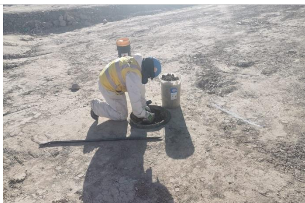
Foto 221. Ensayo reemplazo de agua en plataforma a nivel de capa de arcilla.
