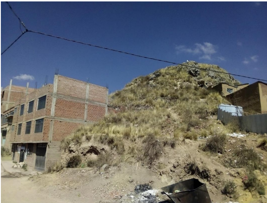
Figura 72. Vista de vivienda susceptible a desprendimiento de detritos y flujo de rocas en coordenadas 390029.76 m E, 8250025.88 m S
