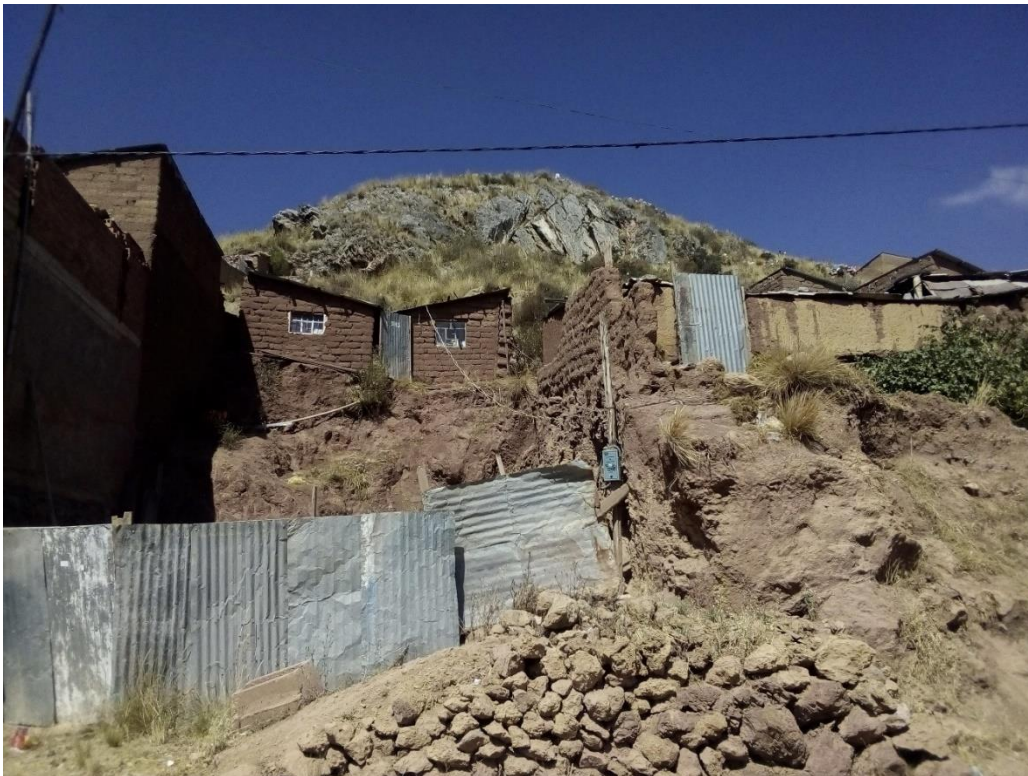
Figura 75. Vista de vivienda sobre cresta de corte de talud para vivienda en coordenadas 390205.17 m E, 8249960.14 m S
