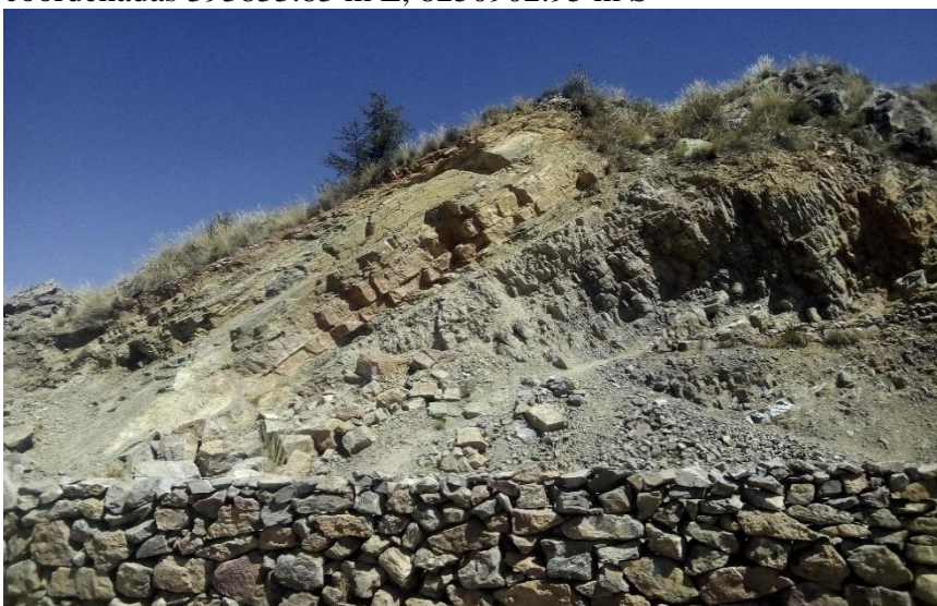
Figura 46. Vista de zona de riesgo por caídas y desplazamiento plano en coordenadas 393559.83 m E, 8252324.83 m S
