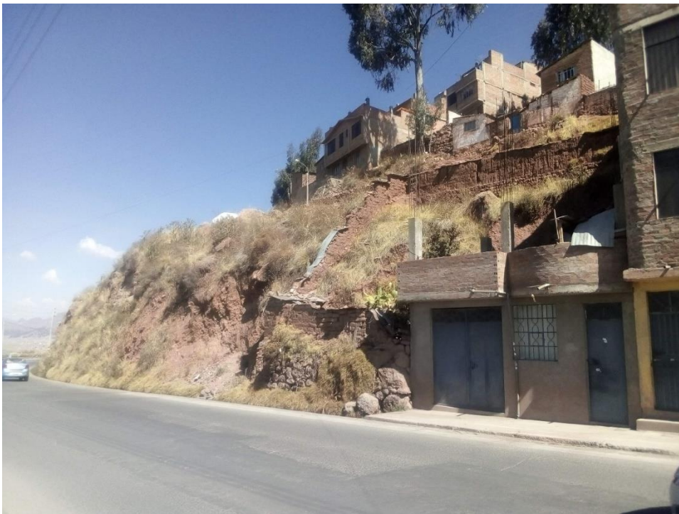
Figura 94. Vista de talud colindante a vía de acceso a la ciudad de Puno y viviendas en ladera de pendiente alta en coordenadas 389623.85 m E, 8249400.57 m S.
