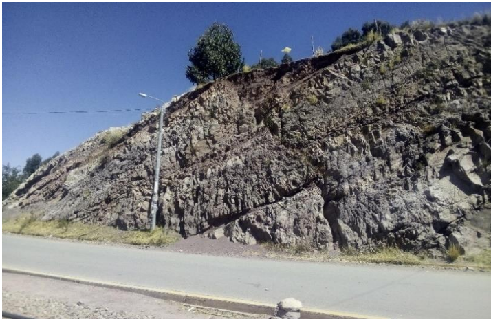
Figura 38. Corte de talud con falla local en coordenadas 394018.87 m E , 8250823.12 m S
