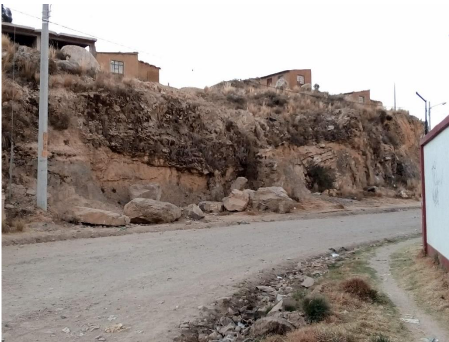
Figura 112. Vista de corte de talud horizontal con presencia de viviendas en la cresta. en coordenadas 392731.30 m E, 8245800.78 m S
