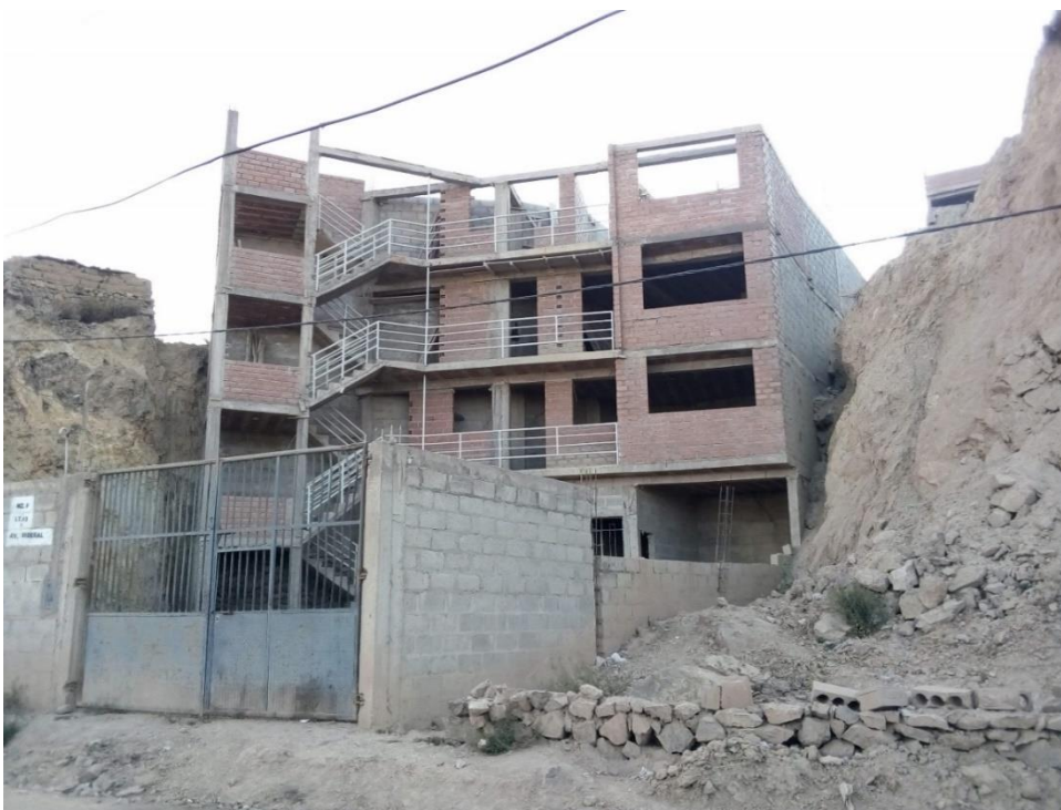
Figura 114. Vivienda colindante a talud de corte con desprendimiento de detritos y rocas suelta en coordenadas 392663.84 m E, 8245757.90 m S
