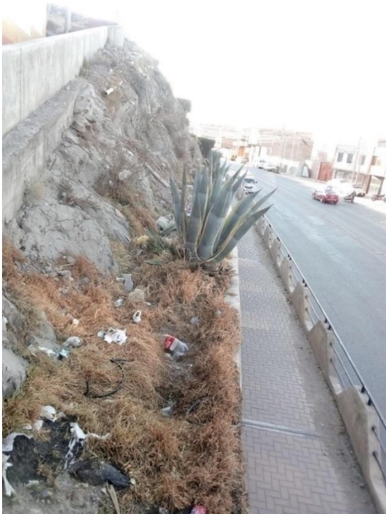
Figura 115. Vista de zonas de estabilización de pendiente alta, colindante a vía interprovincial en coordenadas 392622.81 m E, 8246446.96 m S
