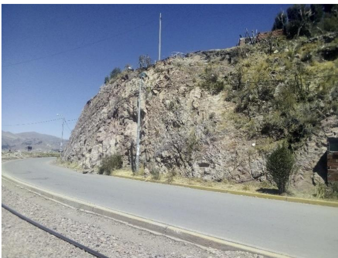
Figura 40. Vista de corte lateral de talud , con presencia de viviendas en la cresta en coordendas 394018.87 m E , 8250823.12 m S
