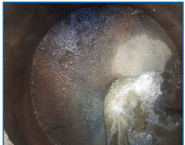
VISTA POR DENTRO DE BUZÓN Bz:020
