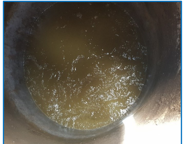
VISTA POR DENTRO DE BUZÓN Bz:025
