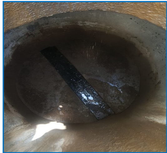
VISTA POR DENTRO DE BUZÓN Bz:001
