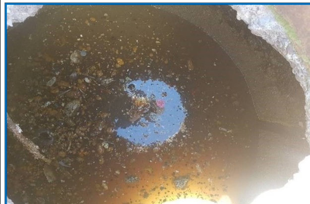
VISTA POR DENTRO DE BUZÓN Bz:045
