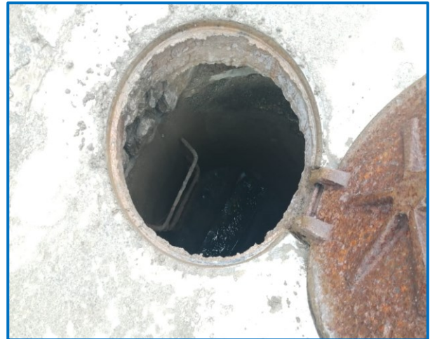
VISTA POR DENTRO DE BUZÓN Bz:027
