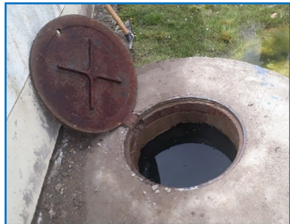
VISTA POR DENTRO DE BUZÓN Bz:044
