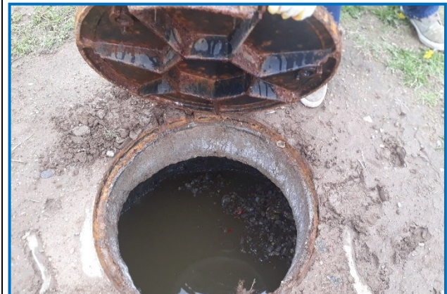
VISTA POR DENTRO DE BUZÓN Bz:040
