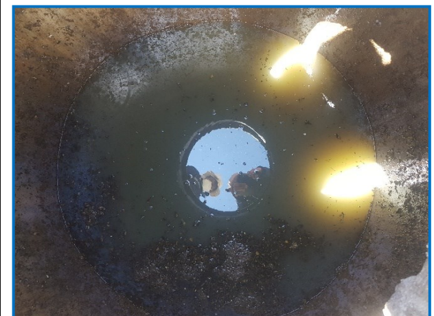
VISTA POR DENTRO DE BUZÓN Bz:031
