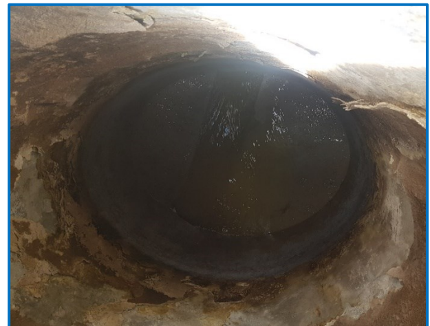
VISTA POR DENTRO DE BUZÓN Bz:021
