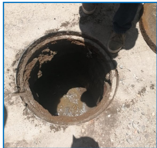
VISTA POR DENTRO DE BUZÓN Bz:013
