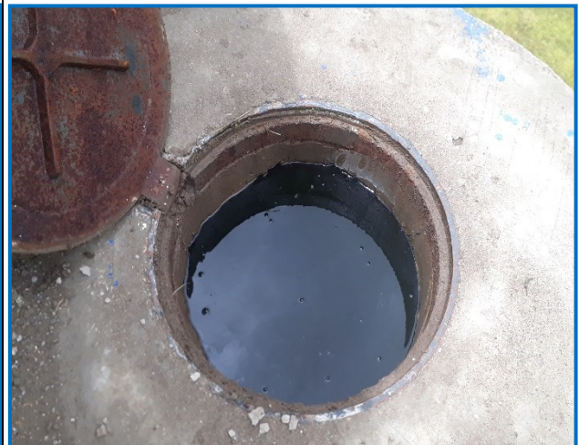
VISTA POR DENTRO DE BUZÓN Bz:038
