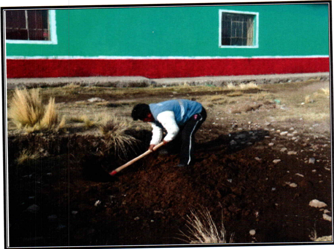
EN LA FOTO SE OBSERVA REALIZANDO LA CALICATA N° 01 EN EL I.E.T.A. SORAPA DISTRITO DE JULI PROVINCIA DE CHUCUITO JULI - PUNO.
