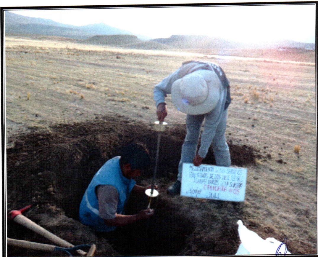
EN LA FOTO SE OBSERVA REALIZANDO EL ENSAYO DPL EN EL I.E.T.A. SORAPA DISTRITO DE JULI PROVINCIA DE CHUCUITO JULI - PUNO.
