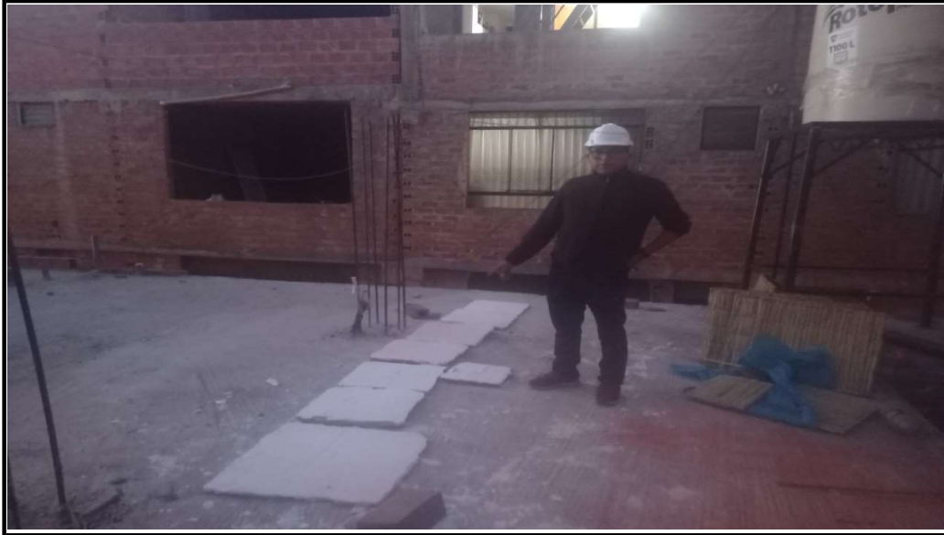
Fotografía 23. PANEL CON EL IMPACTO DE ENERGIA 1KG
