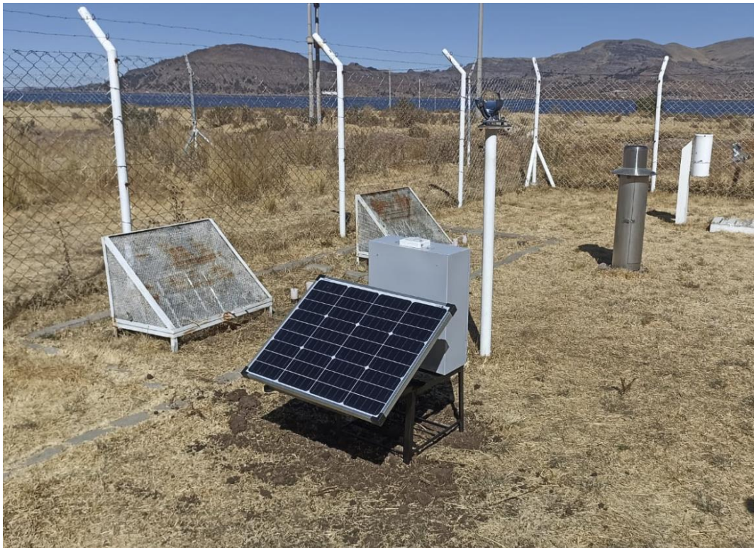
Figura 36. Módulo de monitoreo contigua a Heliógrafo
