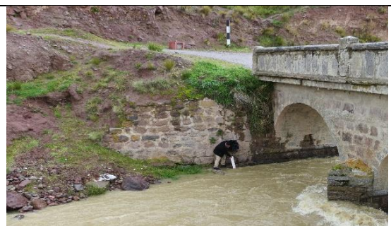
Actividad erosiva y debilitamiento en laterales de conexión al puente Macusani, debido an las fuertes precipitaciones pluviales.
