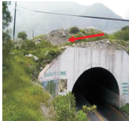
Figura 115. Paso de flujo de detritos sobre túneles Nota. Guía instructiva de Recomendaciones Estructurales (2011) - INDECI
