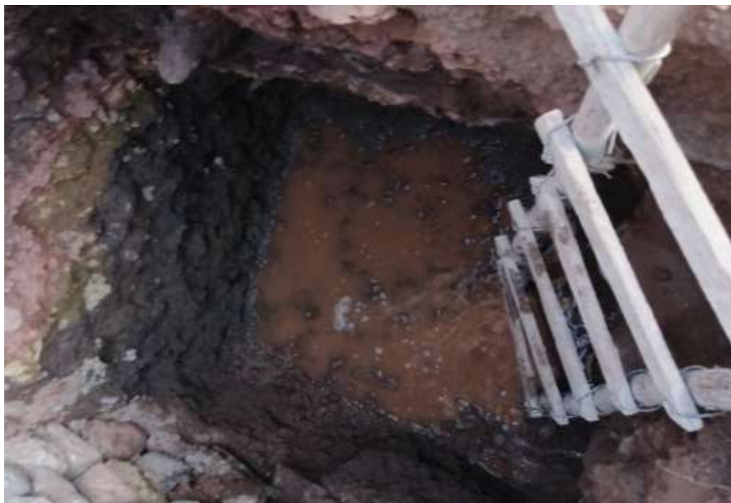
Figura 14. Presencia de aguas subterráneas (Nivel freático)
