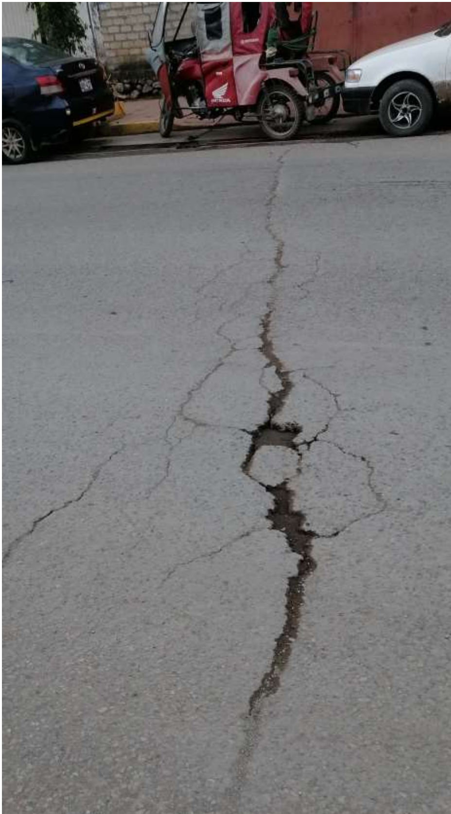
Foto 4. Fisuras en la carpeta asfáltica de la carretera Panamericana (Urb. Bellavista)
