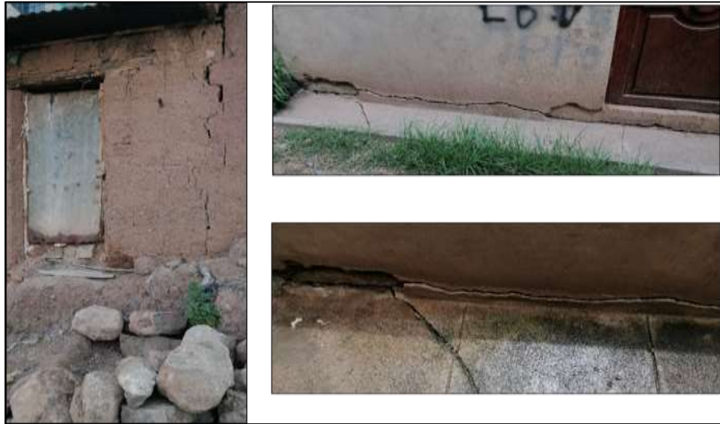
Figura 13. Fisuras generadas por reptación de suelo en la urbanización Bellavista
