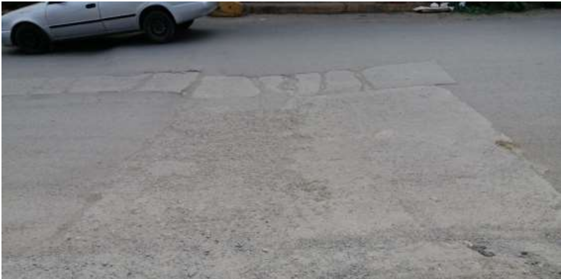
Foto 5. Hundimiento de la plataforma de la carretera Panamericana (Urb. Bellavista)
