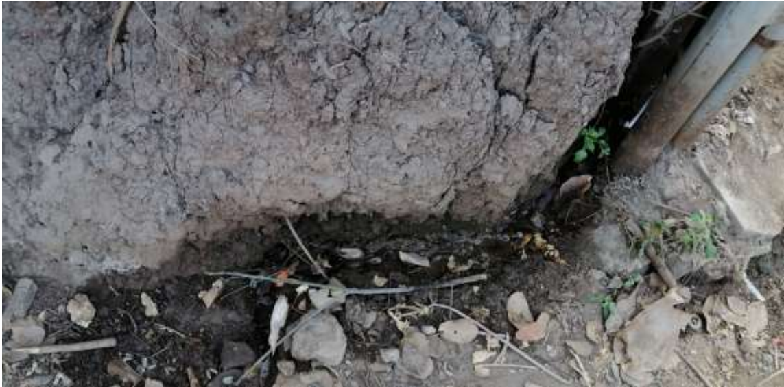
Foto 7. Presencia de aguas subterráneas en pie de talud superior de la carretera Panamericana (Urb. Bellavista).
