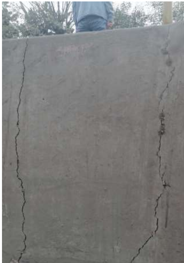
Foto 8. Fisuras en muro de contención, talud inferior de la carretera Panamericana (Urb. Bellavista).
