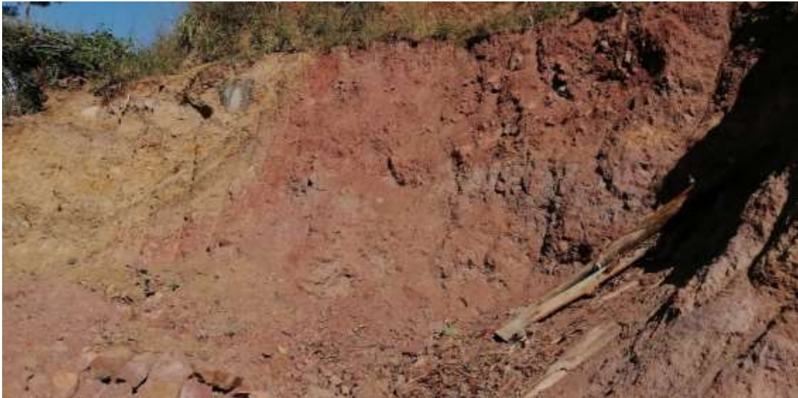
Foto 2. Corte artificial, talud de carretera que muestra el estrato del suelo
