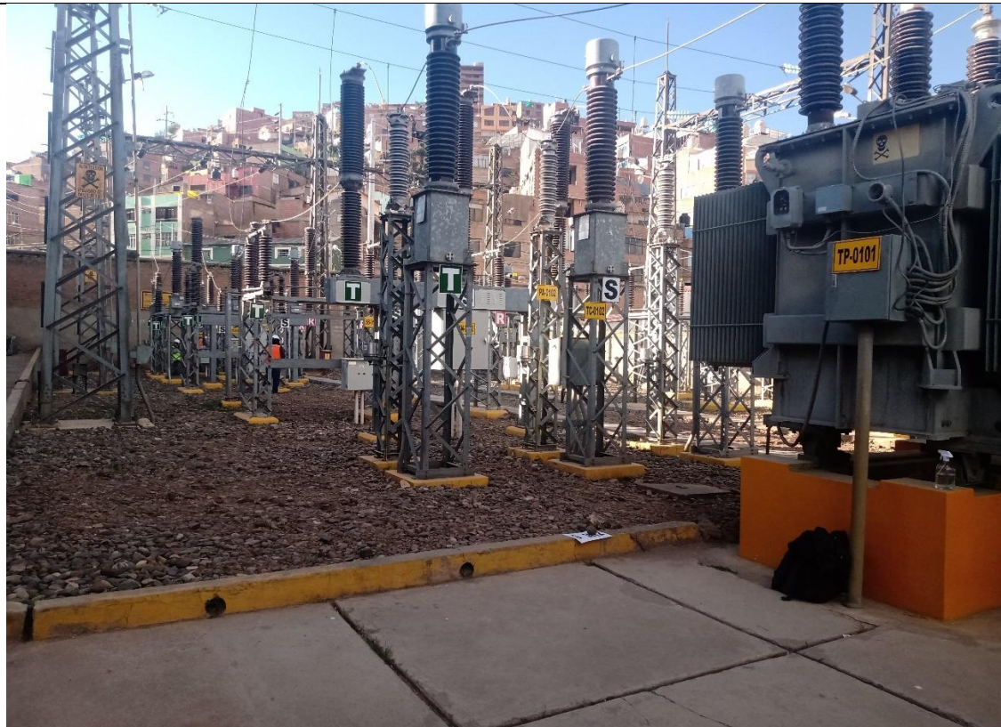
Patio de llaves de la Subestación Eléctrica de Transformación – Bellavista – Puno
