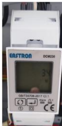
Figura 3.5: En corriente CC, el medidor eléctrico multiparámetro
