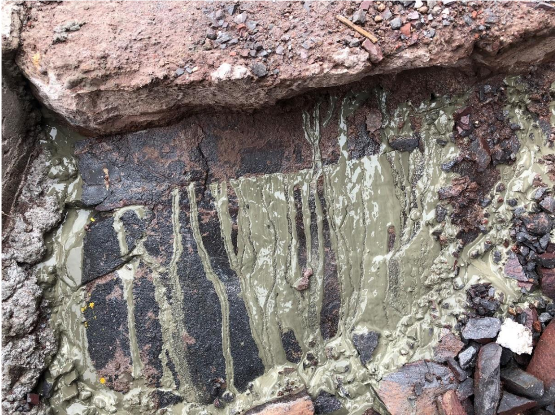
Figura 58. Flujo de lechada a través de discontinuidades en afloramiento de andesita.
