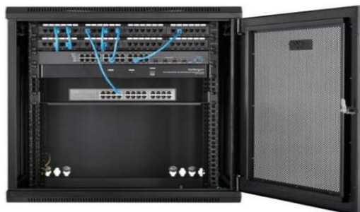
Figura 12. Rack tipo abierto
