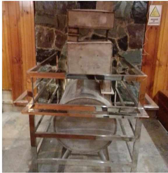
Figura 28: Estructura que brinda la temperatura a la cámara seca de la sauna Copacabana
