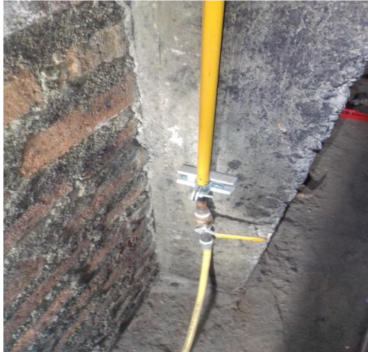
Figura 26: Tubería de gas con llave de paso con manguera de gas para alimentar de combustible el quemador industrial
