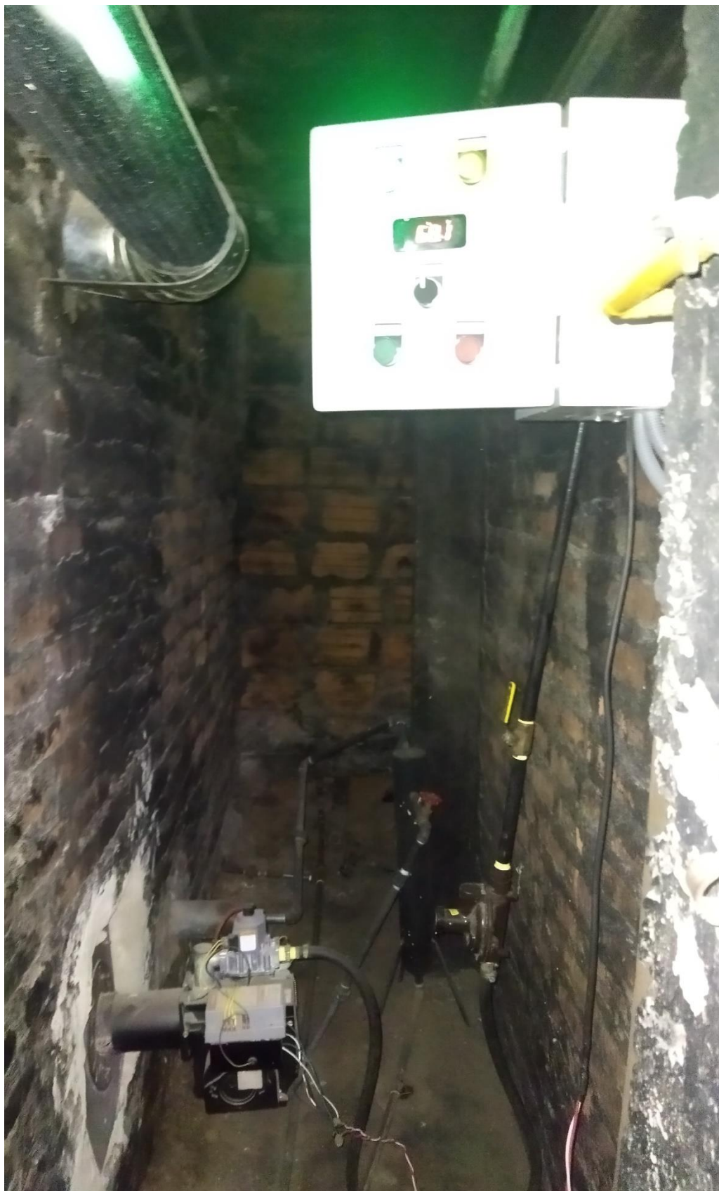
Figura 30: Parte trasera de la cámara seca con el sistema implementado
