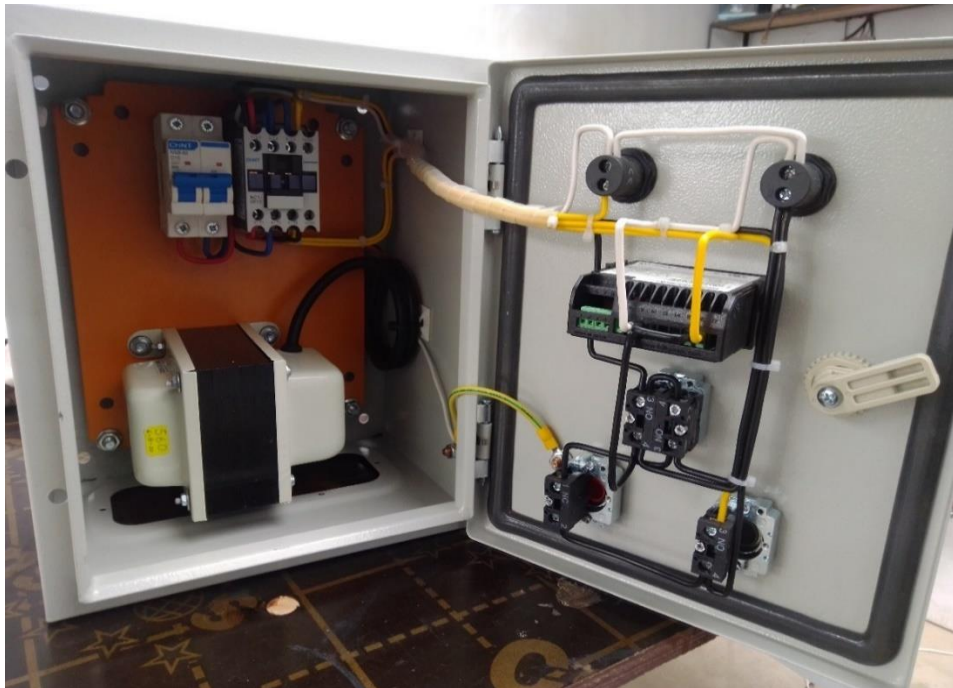
Figura 16: Tablero de control del sistema
