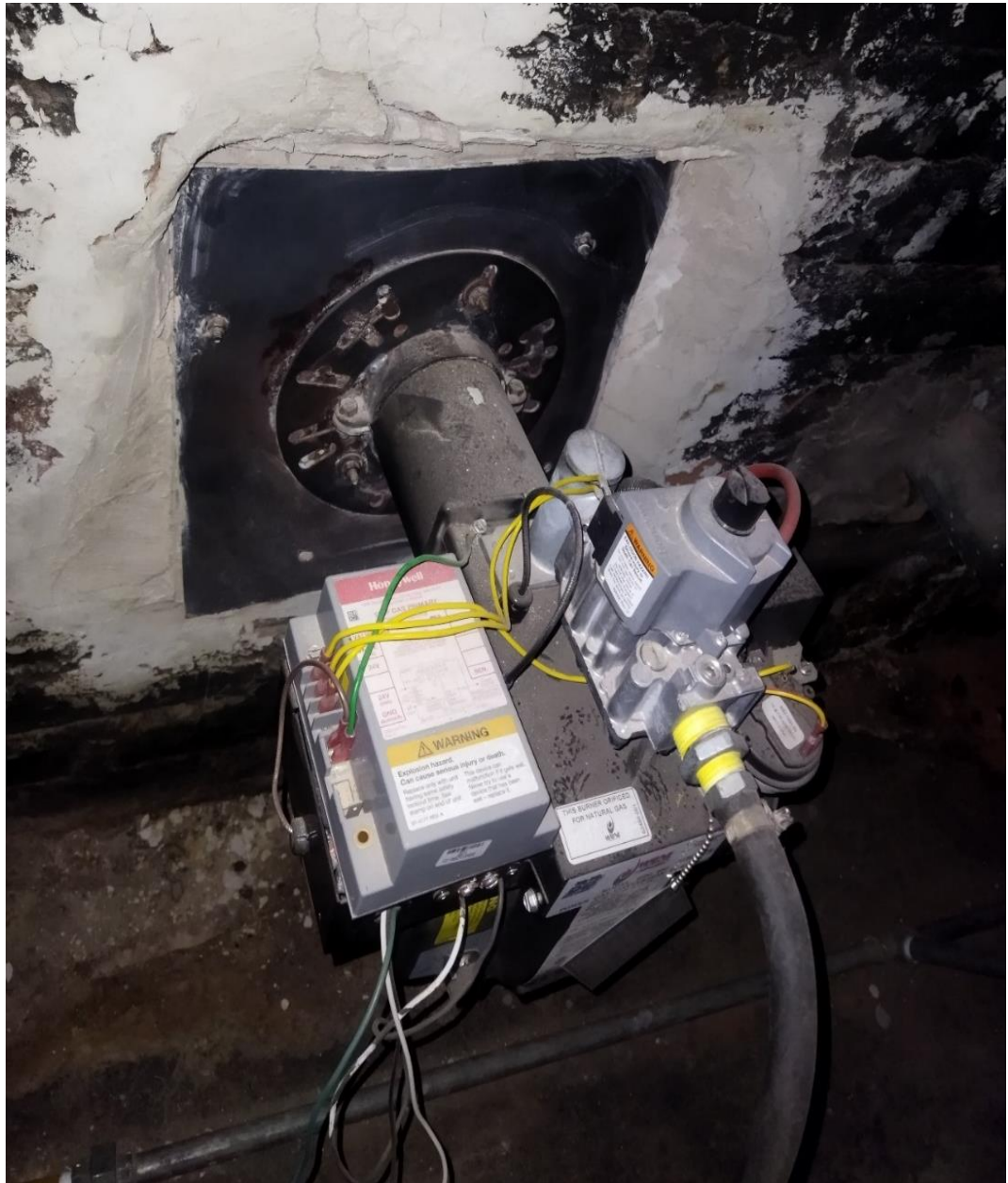
Figura 19: Quemador industrial ya implementado
