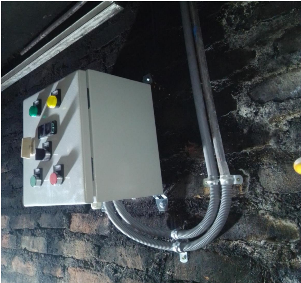
Figura 18: Tablero de control instalado en el cuarto de máquinas de la sauna
