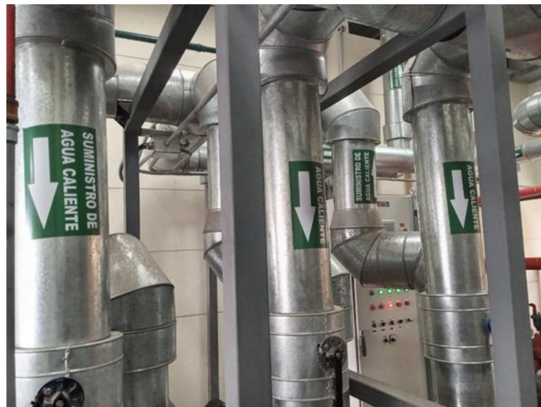
Figura 15: Tubería de suministro de agua caliente.
