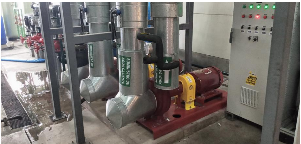
Figura 39: Bombas secundarias (suministro de agua caliente).
