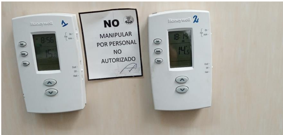
Figura 35: Termostatos de las unidades de tratamiento de aire.
