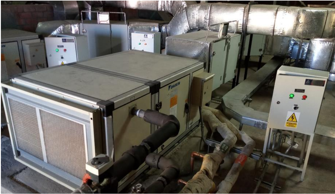
Figura 32: Unidad de tratamiento de aire.
