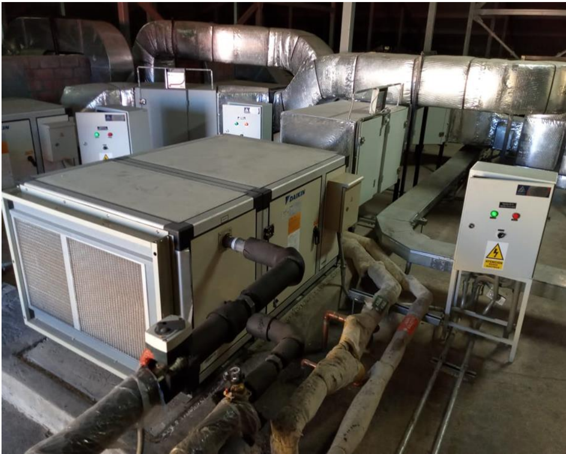
Figura 13: Unidad de tratamiento de aire.
