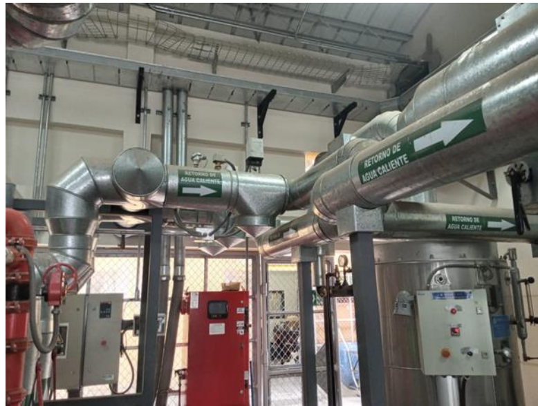
Figura 16: Tubería de retorno de agua caliente.
