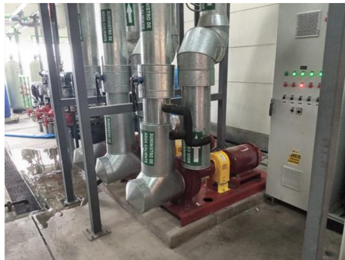
Figura 19: Casa de máquinas sistema de calefacción.
