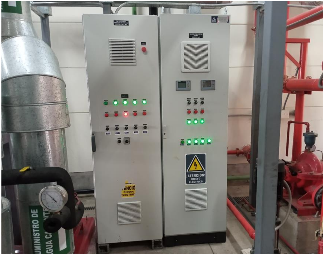
Figura 40: Tablero de control del sistema de calefacción.
