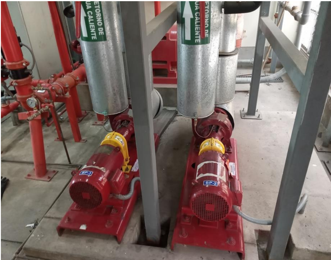
Figura 38: Bombas primarias (alimentación de calderos).
