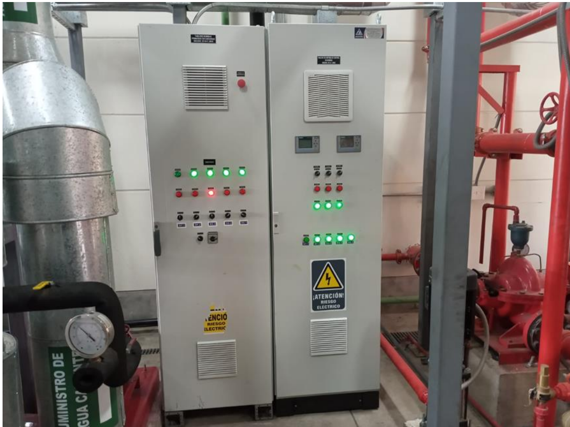
Figura 12: Tablero de control del sistema de calefacción.
