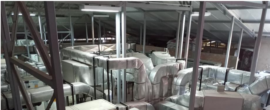
Figura 14: Ducto de inyección y retorno de aire
