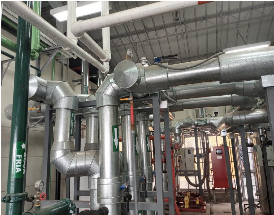
Figura 37: Tuberías de suministro y retorno de agua caliente.
