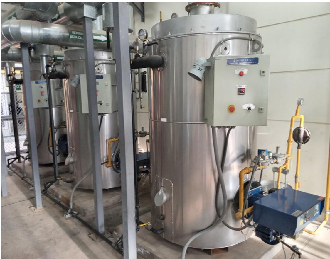
Figura 36: Calderas del sistema de calefacción del HSMP.
