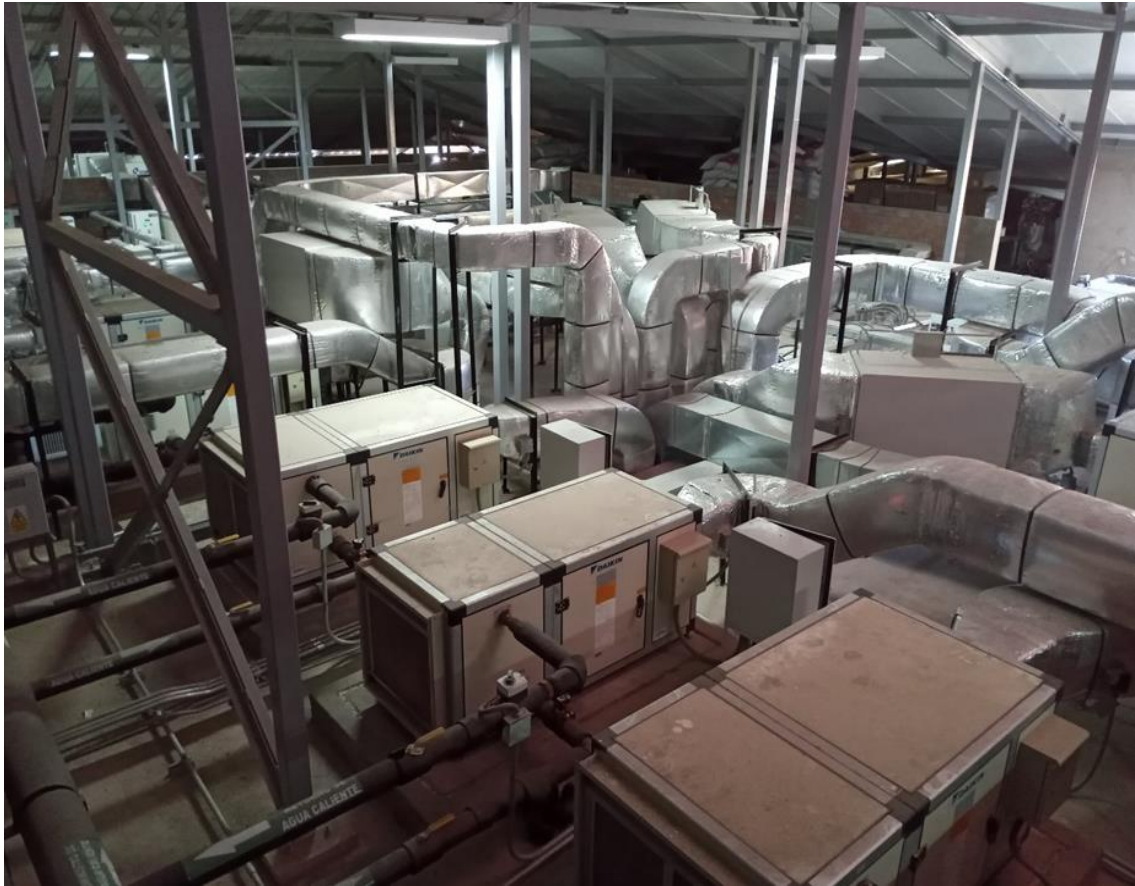
Figura 31: Sistema de calefacción sector D HSMP.
