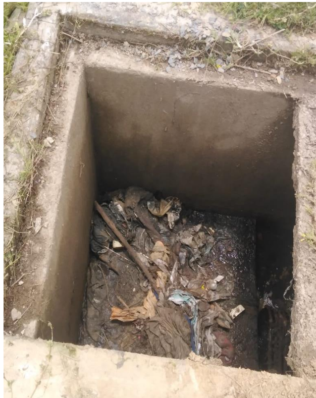
Figura 9. Falta de mantenimiento en la Cámara de Entrada (Buzoneta).
