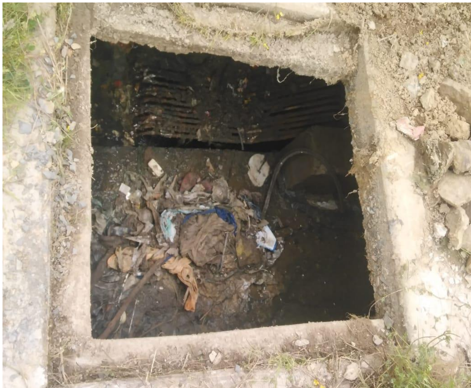
Figura 17. Presencia de residuos en las rejillas
