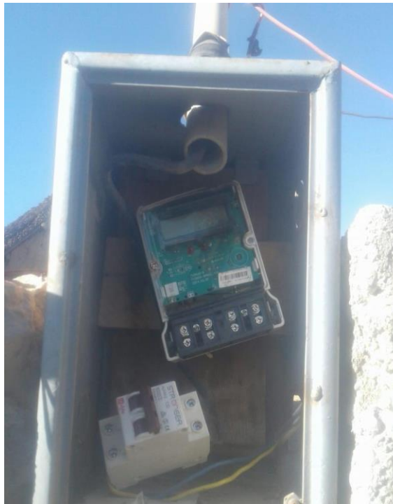
Medidor de energía dañado y manipulado
