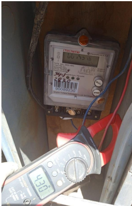
Medidor de energía manipulado
