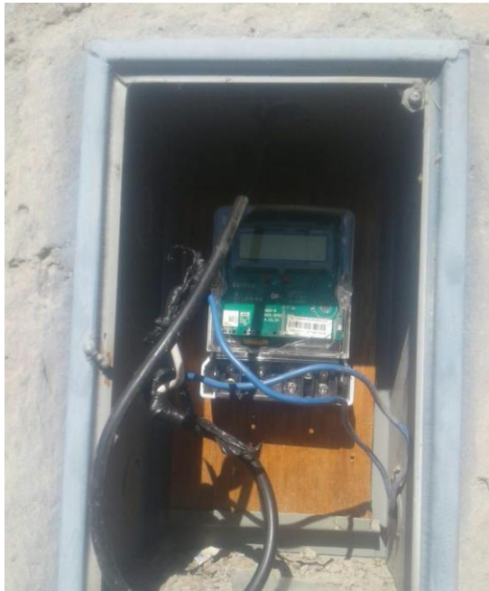
Medidor de energía manipulado
