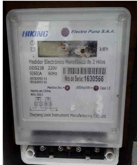
Medidor de energía dañado
