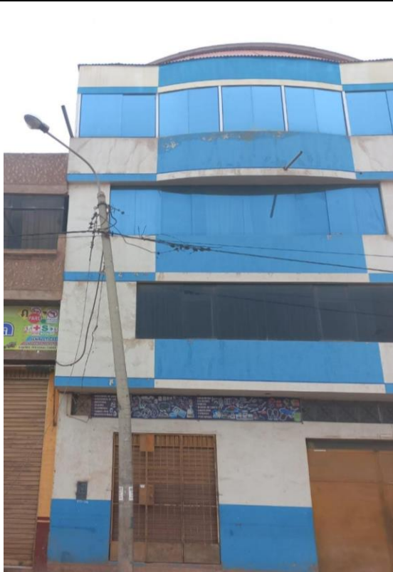
Estructura de red secundaria fisurada e inclinada
