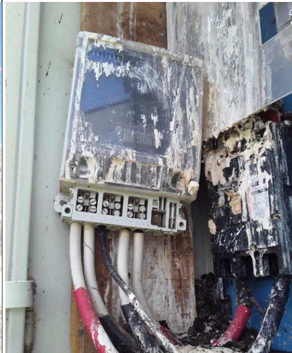
Medidor de energía expuesto
