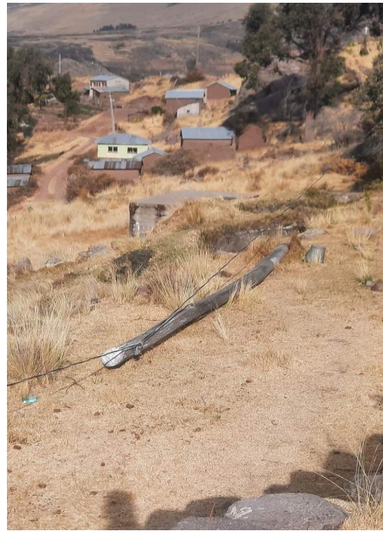
Estructura de red secundaria caída
