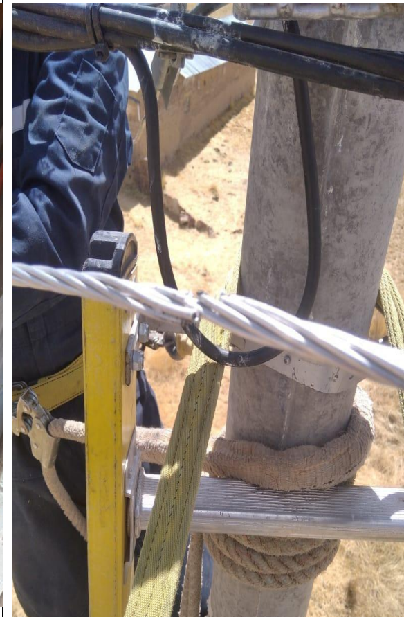
Conductor autoportante dañado
