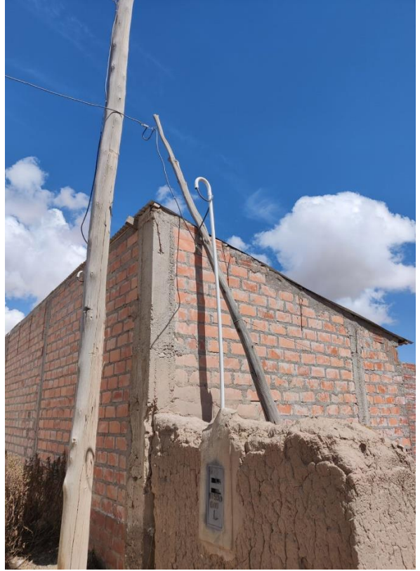
Acometida con soporte de madera inclinada
