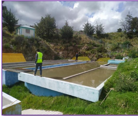
Sedimentador primario de PTAR Chucuito
