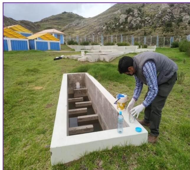
Cámara de cloración PTAR Capachica
