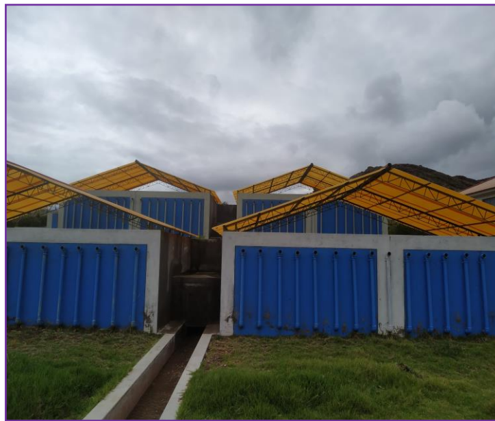
Filtro percolador PTAR Capachica
