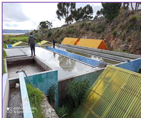
Sedimentador secundario de PTAR Chucuito
