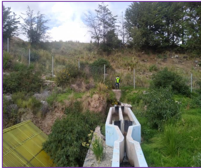
Medidor Parshall de PTAR Chucuito
