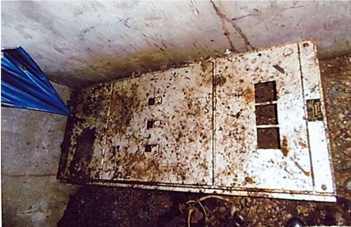
Figura 69. Uno de los tableros, por los suelos y totalmente desmantelado. Fuente: Leonel Castillo (2018).
