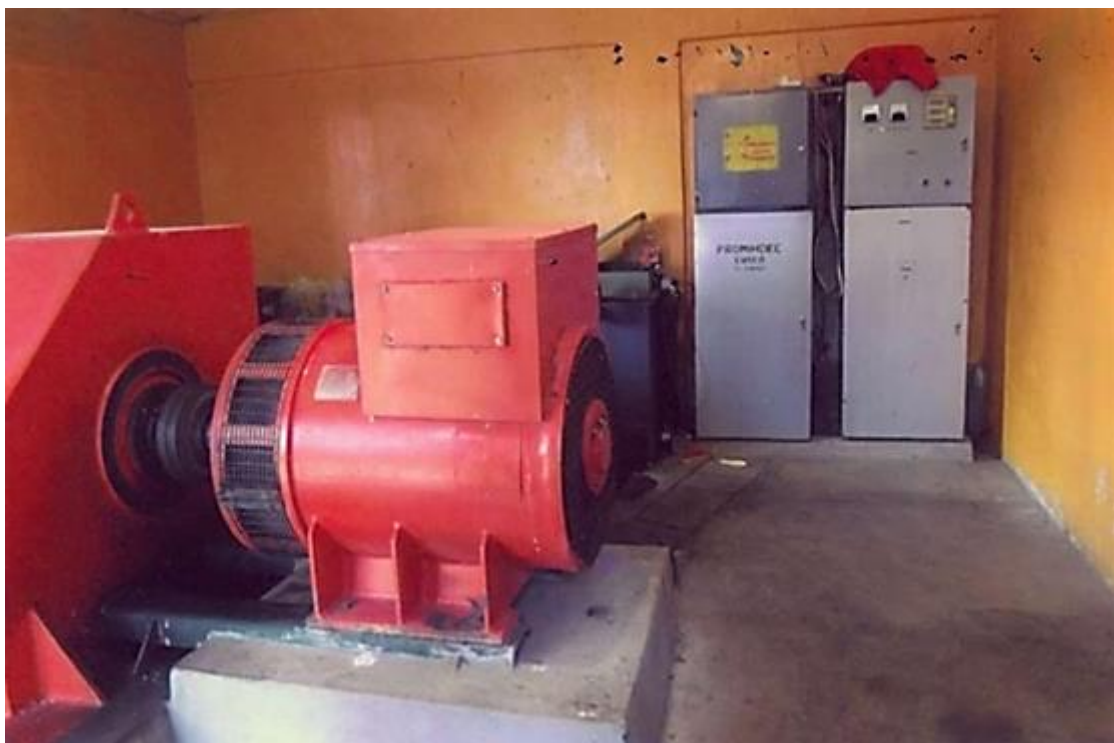
Figura 94. Generador Hidrosatur de 125 kVA, 100 kW, trifásico, 380 V , en pleno servicio. Fuente: Leonel Castillo (2018).
