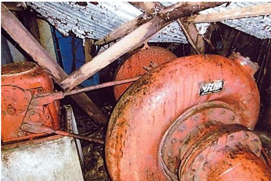
Figura 64. La turbina Francis marca VRM, de 75 kW, también yace aplastada por el techo y en franco proceso de deterioro. Fuente: Leonel Castillo (2018).
