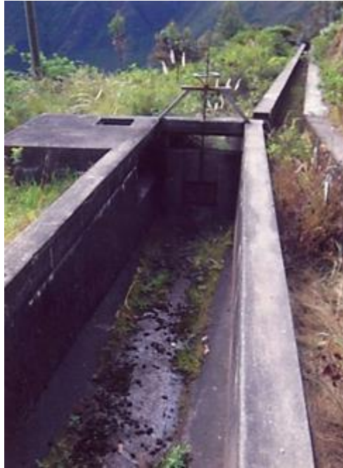
Figura 21. Vista del desarenador. En la parte superior derecha, continuación del canal, obra ejecutada para abastecer a la minicentral “Ollachea II” (1998). Fuente: Leonel Castillo (2018).
