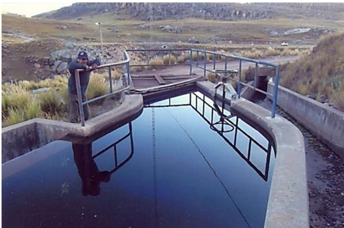
Figura 76. Desarenador, cámara de carga y rebose (hacia la izquierda), de la minicentral hidroeléctrica Tocca. Al frente, la carretera interoceánica. Fuente: Leonel Castillo (2018).
