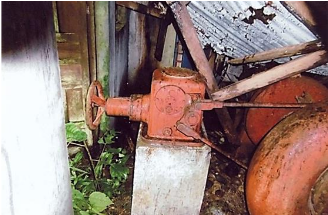
Figura 65. La casa de máquinas era muy estrecha, ajustada apenas al tamaño de los equipos, no daba comodidad alguna para trabajar en ella. Fuente: Leonel Castillo (2018).
