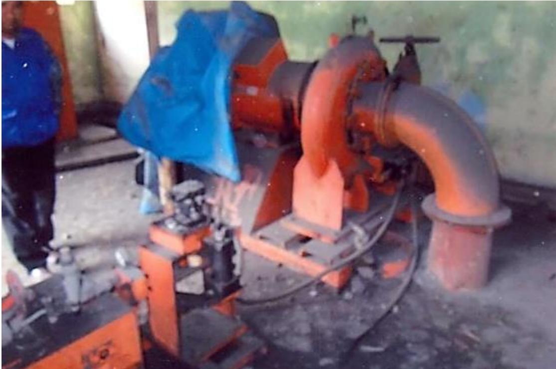
Figura 25. Conjunto de turbina tipo Francis conectada a generador marca ALGESA de 93,75 kVA (75 kW), trifásico, 220 voltios, en buenas condiciones. (Fabricado en 1984). Fuente: Leonel Castillo (2018).
