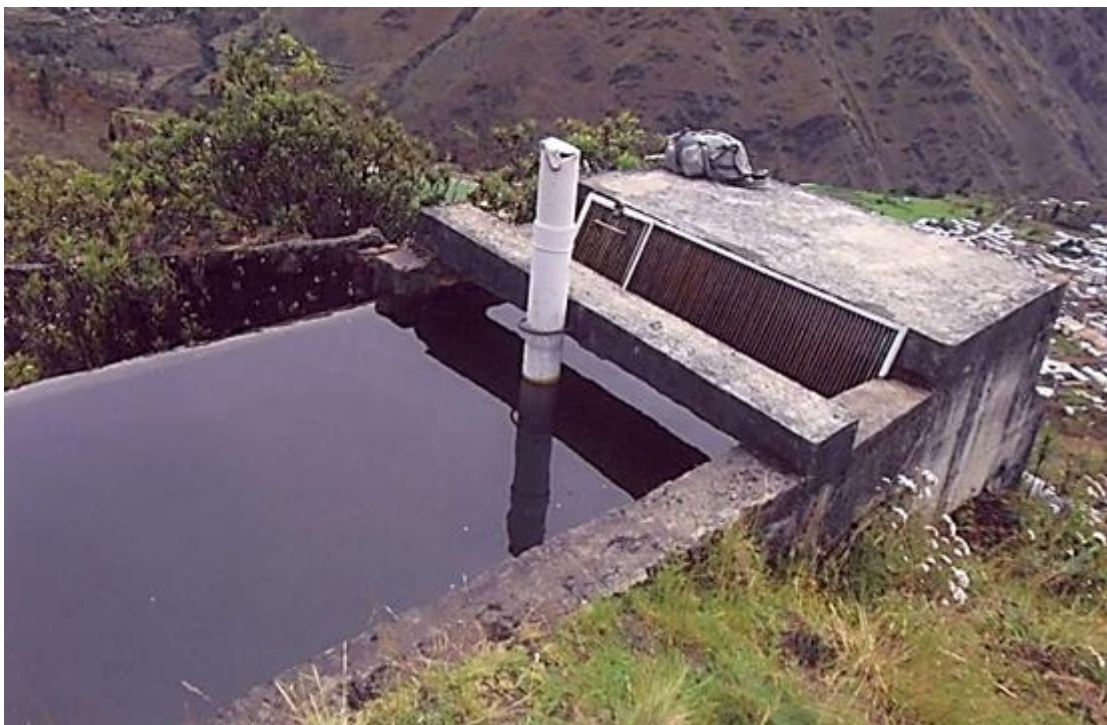
Figura 90. Desarenador y rejilla que permiten el ingreso de agua limpia a la cámara de carga Fuente: Leonel Castillo (2018).
