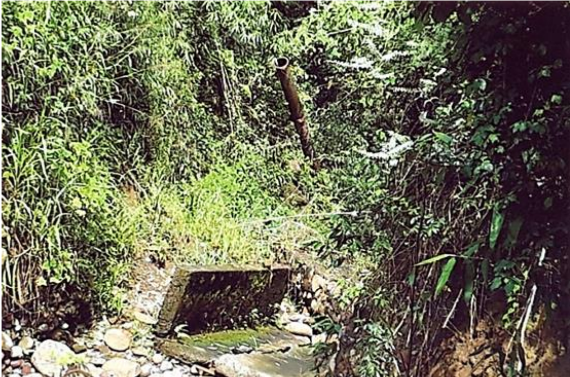
Figura 59. Ya hace unos 2 años que la viga se vino abajo. Gran parte del terreno se deslizó; se ve parte del desarenador fuera de su lugar original y un tramo de la tubería “al aire”. Fuente: Leonel Castillo (2019).
