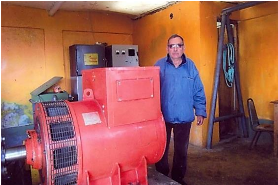
Figura 95. El tésista en la casa de máquinas de la minicentral hidroeléctrica Ayapata. Fuente: Leonel Castillo (2018).
