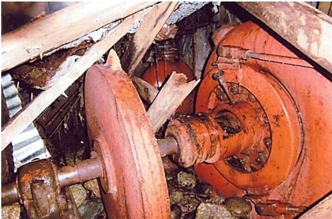
Figura 68. Se aprecia que el desastre es total. Fuente: Leonel Castillo (2018).
