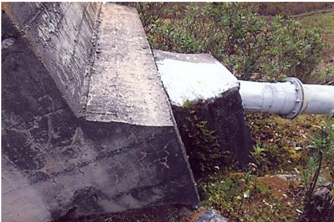
Figura 88. Arranque de la tubería de presión, de acero, (12"Ø) Fuente: LeonelCastillo (2018).
