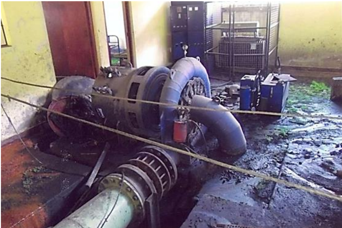
Figura 43. Vista general del equipamiento electromecánico, con muchos elementos faltantes.
