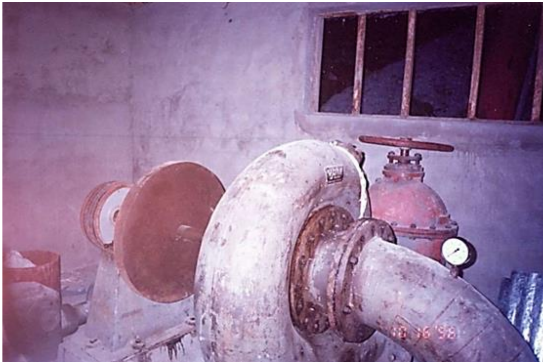
Figura 61. Hacia finales de 1996, los equipos ya estaban fuera de servicio por ausencia del operador, pero se hallaban en aceptables condiciones.
