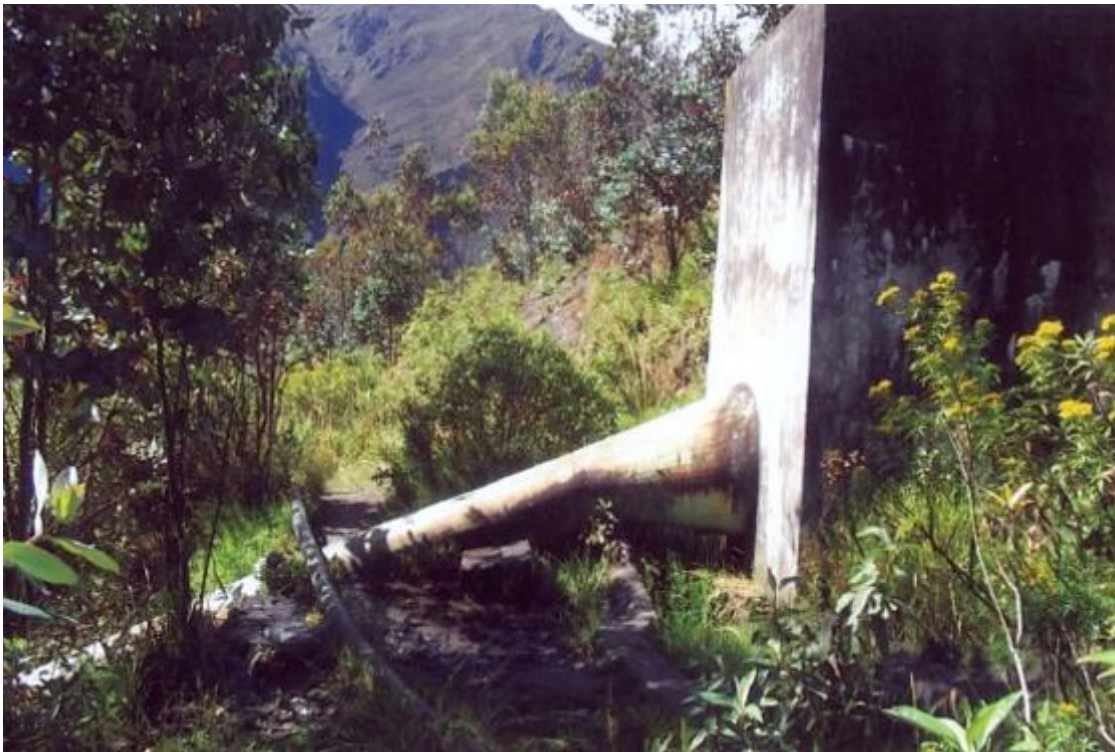
Figura 35. Inicio de la tubería de presión, de acero, 19''Ø. Fuente: Leonel Castillo(2018).
