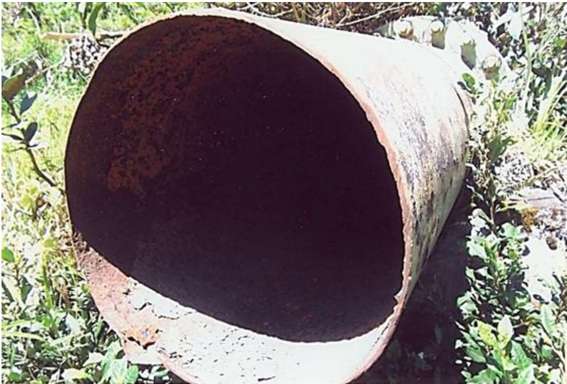
Figura 37. Vista que muestra un tramo de la tubería, abandonada, parcialmente deteriorada. Fuente: Leonel Castillo (2018).
