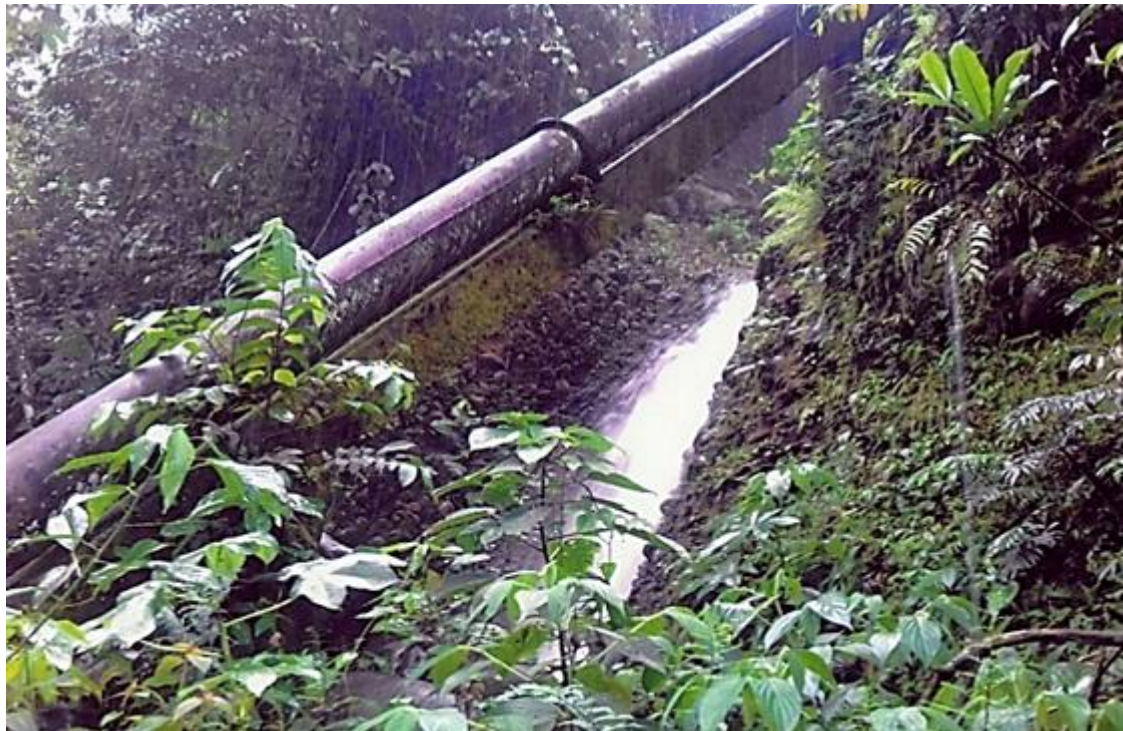
Figura 57. Tramo de la tubería de presión (12"Ø) que descansaba sobre una viga de concreto armado. Ya todo se vino abajo. Fuente: Leonel Castillo (2006).
