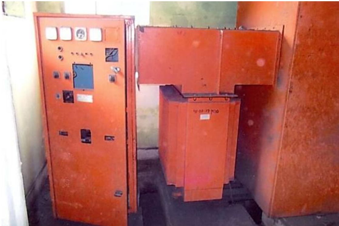
Figura 27. Conjunto: tablero de control, transformador de 80 kVA, Brown Boveri. Fuente: Leonel Castillo (2018).
