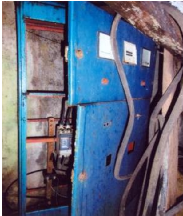
Figura 70. Otro tablero de control, sosteniendo una parte del techo caído. Fuente: Leonel Castillo (2018).
