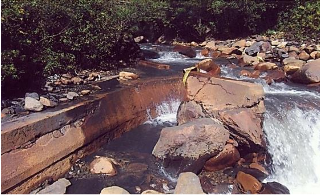
Figura 15. Captación de agua en el río Chillichaca. Al medio, lado izquierdo, el canal completamente lleno de piedras arena y tierra. Fuente: Leonel Castillo (2018).
