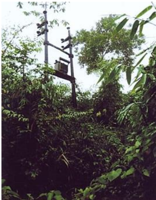
Figura 60. Hubo esta subestación trifásica biposte (hasta el 2017). Se cayó por desmoronamiento del terreno, (foto de archivo personal del tesista). Fuente: Leonel Castillo (2006).
