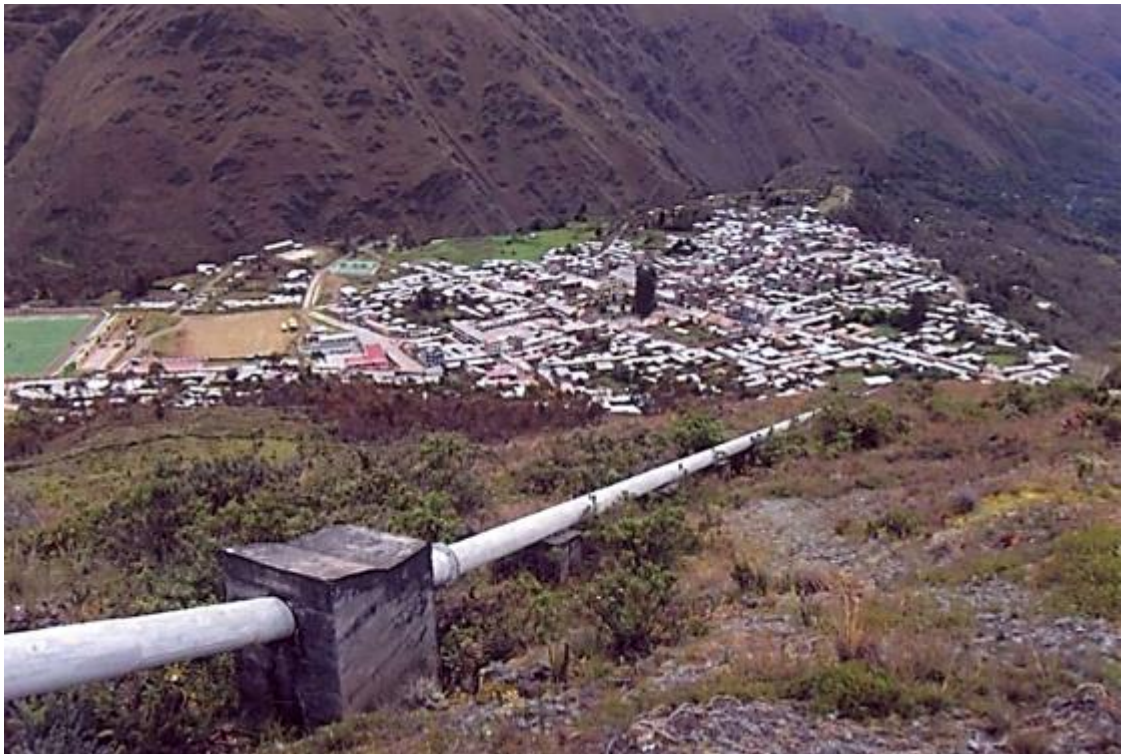
Figura 83. Un tramo corto de la tubería de presión y vista panorámica del pueblo de Ayapata Fuente: Leonel Castillo (2018).
