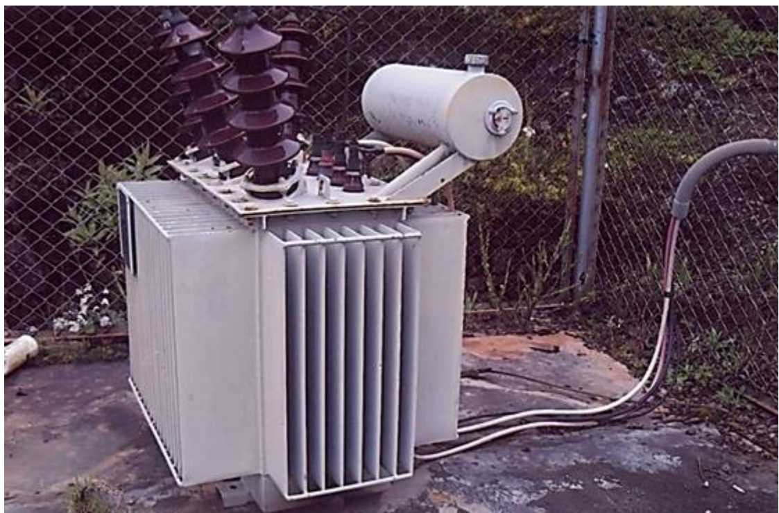
Figura 98. Transformador trifásico ABB, de 160 kVA, instalado en el exterior sobre una loza de concreto y dentro de un enmallado. Fuente: Leonel Castillo (2018).
