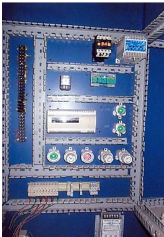
Figura 48. Vista parcial del interior del tablero. Fuente: Leonel Castillo (2019).
