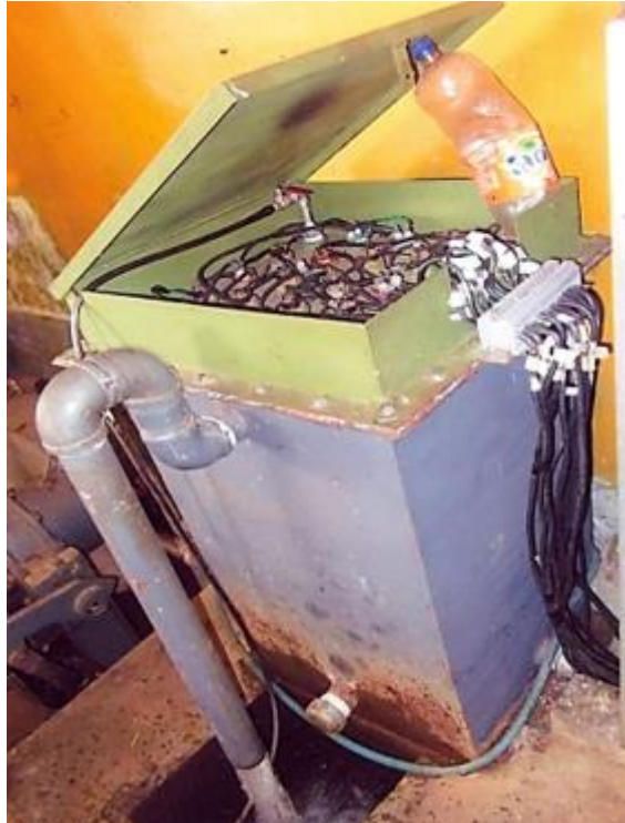
Figura 97. Conjunto de resistencias disipadoras de energía. Fuente: Leonel Castillo (2018).
