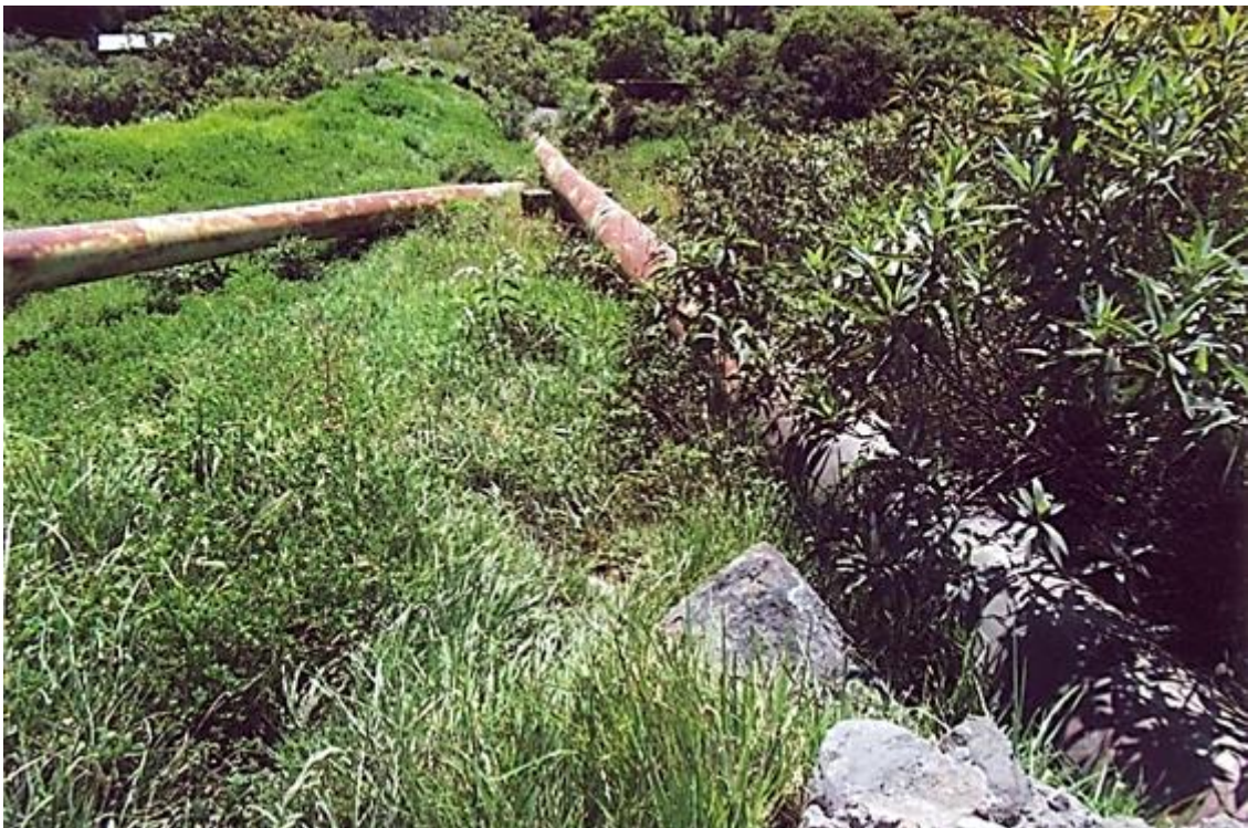
Figura 36. Tramos de la tubería de presión, algunos fueron retirados de su posición original. Fuente: Leonel Castillo (2018).
