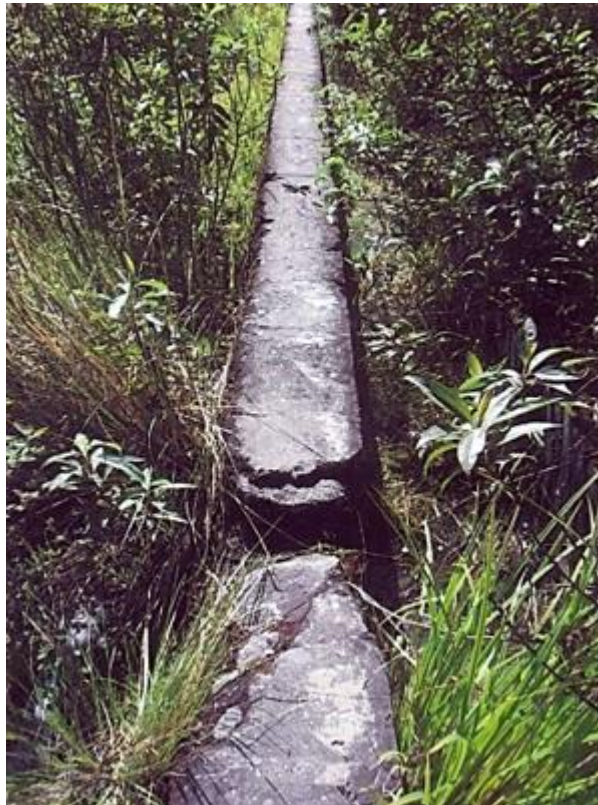
Figura 18. Detalle del regular estado de la pared izquierda del canal. Fuente: Leonel Castillo (2018).
