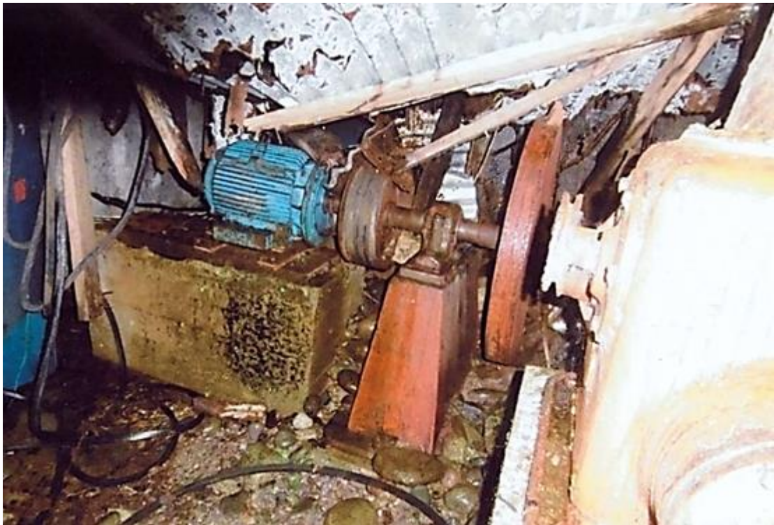
Figura 63. En el 2018, el techo de la casa de máquinas se ha derrumbado, y con material adicional encima de él, aplasta al equipamiento electromecánico. Fuente: Leonel Castillo (2018).
