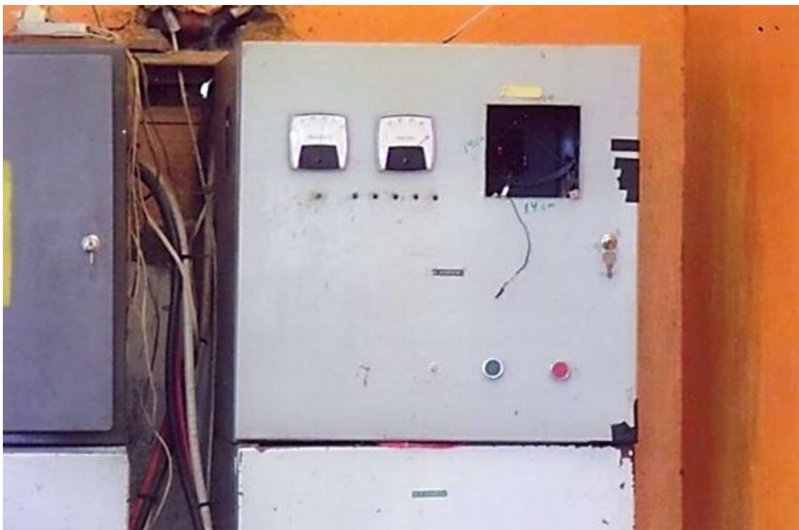
Figura 96. Tablero de control Fuente: Leonel Castillo (2018).
