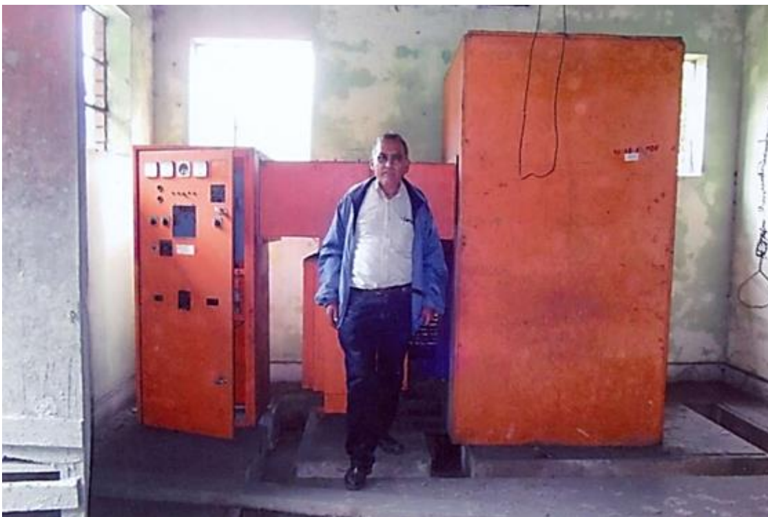
Figura 26. El tesista en la casa de máquinas, detrás de él, el transformador. Fuente: Leonel Castillo (2018).
