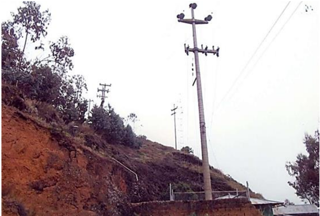
Figura 99. Arranque de las líneas de media tensión (22 900 voltios). Cuando la minicentral es parada con fines de hacerle tareas de mantenimiento, las redes del pueblo son conectadas y abastecidas por las líneas de media tensión del concesionario ELECTROPUNO.
