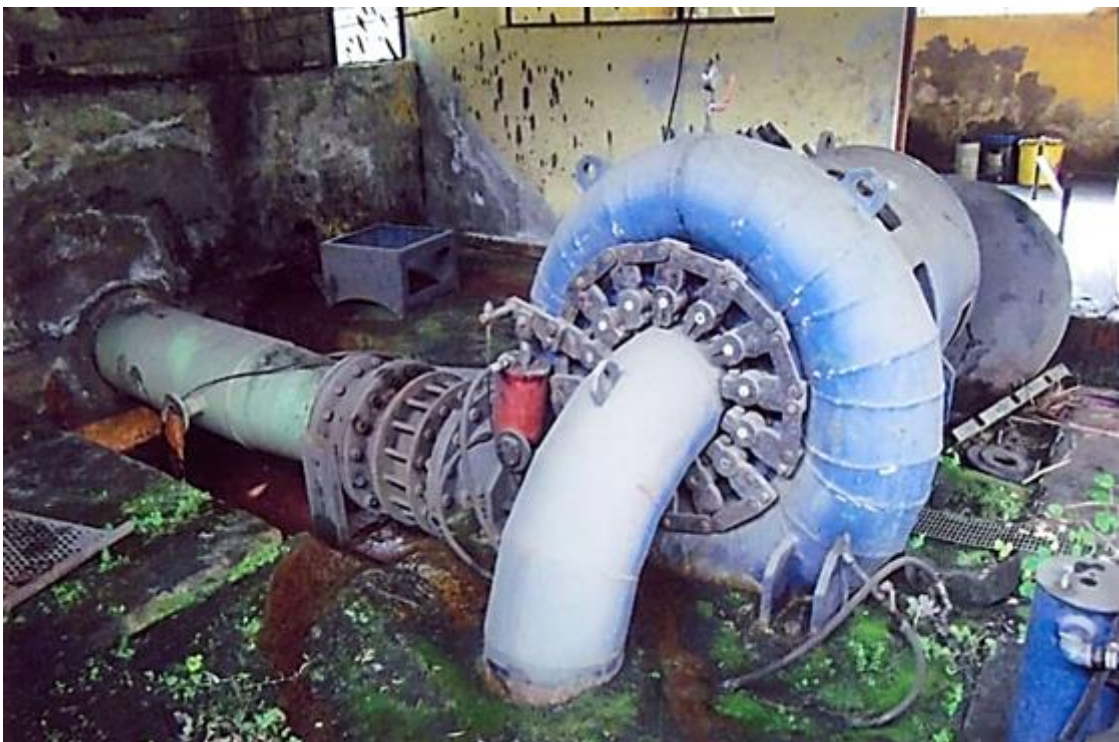
Figura 44. Conjunto de turbina tipo Francis y generador trifásico ALGESA de 150 kW (fabricado en 1998).
