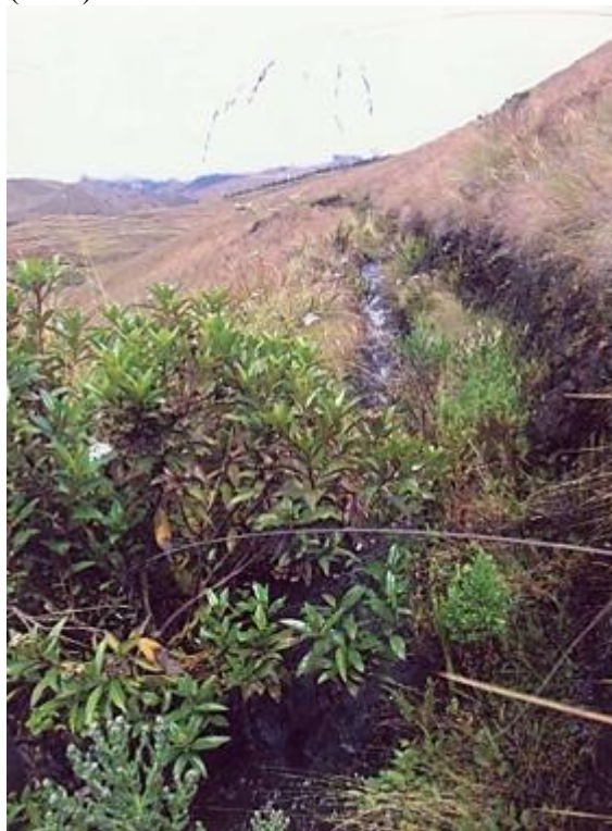
Figura 84. Un tramo del canal rústico de 5 Km, que trae el agua hacia la minicentral desde la laguna Itherqota, construido por los pobladores de Ayapata en 1989. Fuente: Leonel Castillo (2018).
