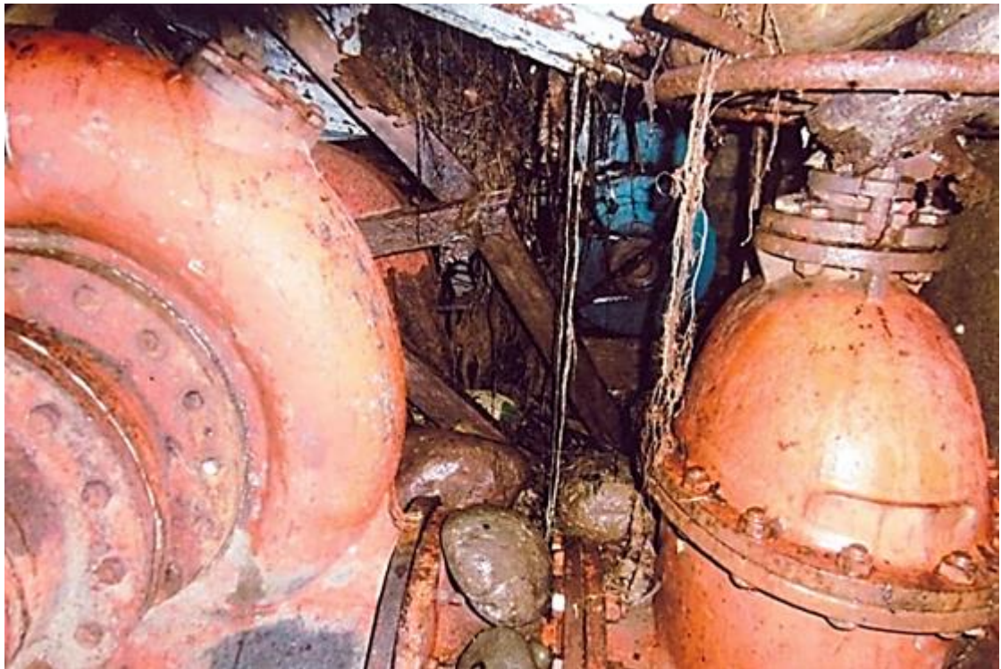
Figura 67. Otra vista de la situación calamitosa del equipamiento electromecánico (2018). Fuente: Leonel Castillo (2018).
