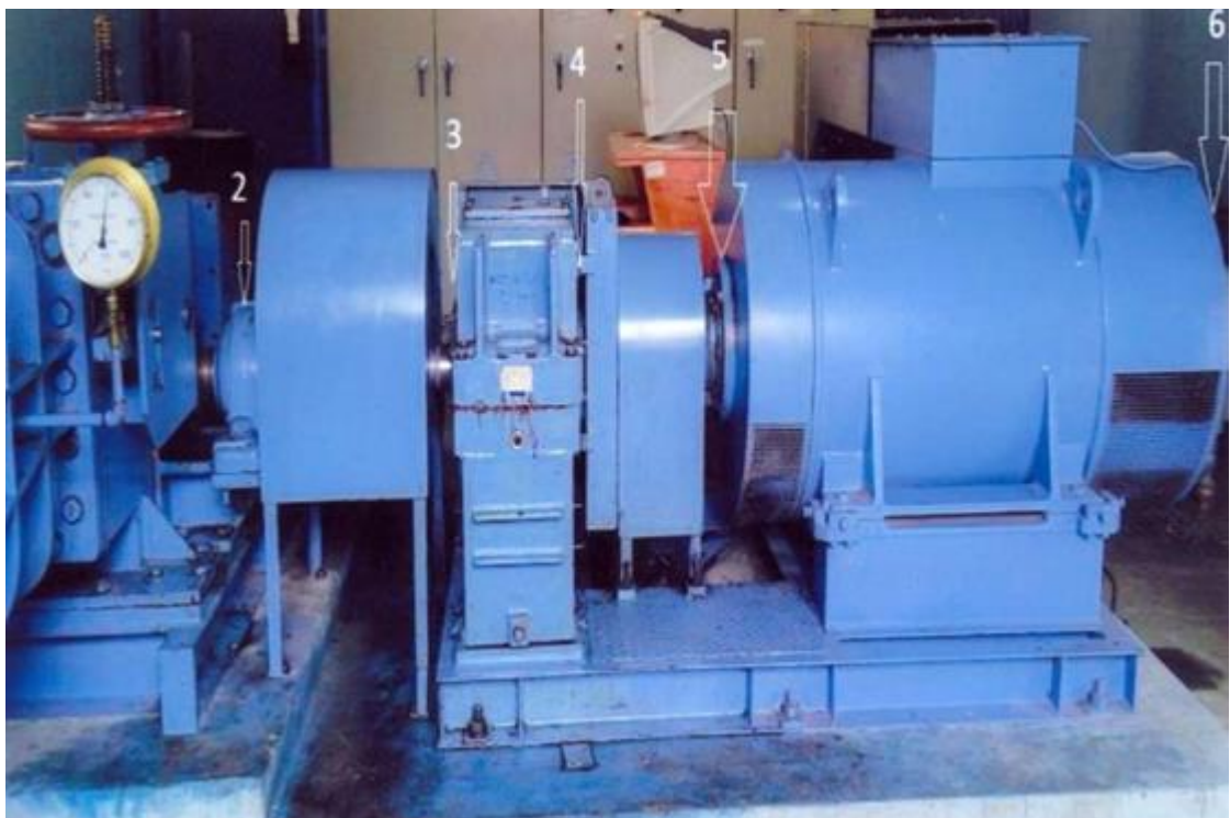
Figura 80. Conjunto de la turbina Michell- Banki y generador (190 kW), en buenas condiciones, totalmente operativos, pero que han dejado de prestar servicio merced a un convenio con la empresa generadora San Gabán. Fuente: Leonel Castillo (2018).
