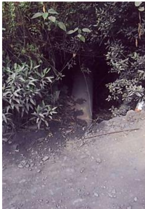
Figura 22. Tramo de la tubería metálica de 16” Ø, en aparente regular estado. Fuente: Leonel Castillo (2018).
