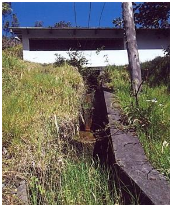
Figura 40. Lado posterior de la casa de máquinas. Se aprecia el canal de descarga del agua con pequeñas cascadas artificiales, construidas para amortiguar la veloz salida del agua.
