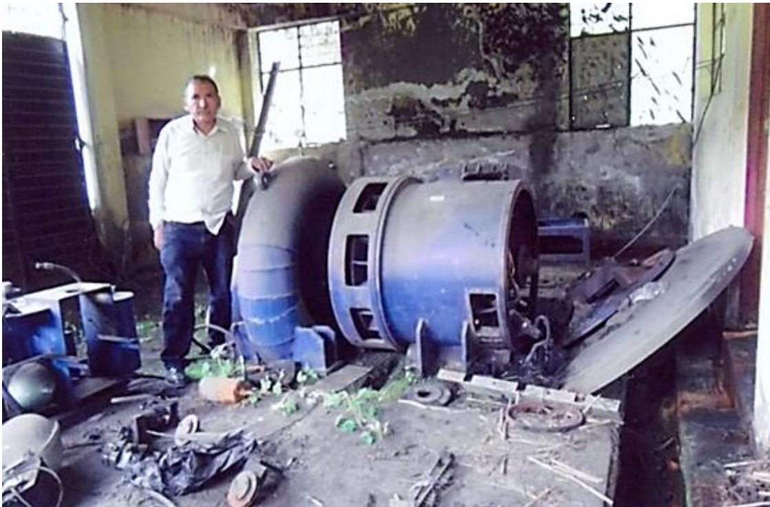
Figura 45. El tesista en la sala de máquinas. Se aprecia el generador parcialmente desmantelado.
