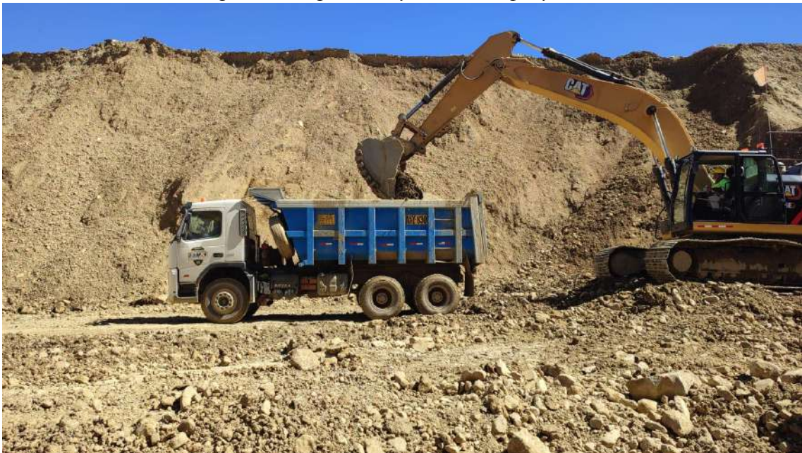
Foto 02 – Movimiento de material aurífero con maquinaria, al fondo se puede apreciar deslizamiento de material suelto por gravedad.
