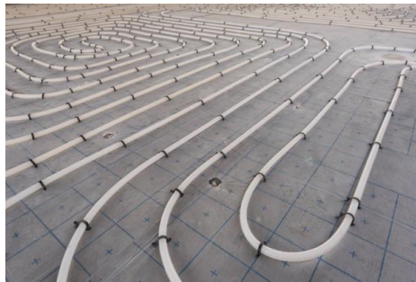
Figura 4: Tuberías del sistema.
