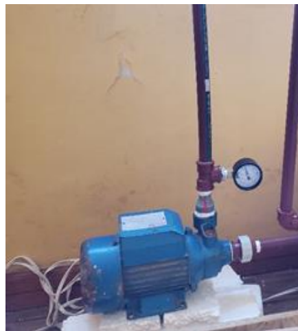
Figura 28: Instalación de Electrobomba Elaborado por el equipo de trabajo.
