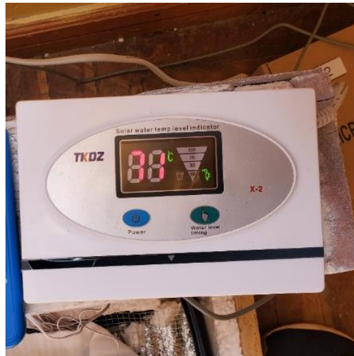
Figura 31: Instalación de un Sensor de Temperatura en el Tanque de Agua Elaborado por el equipo de trabajo.
