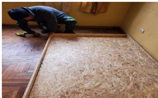
Figura 21: Construcción de la base de módulo. Elaborado por el equipo de trabajo.
