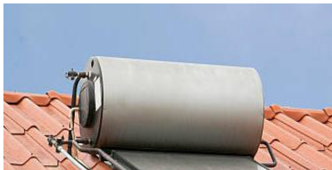
Figura 3: Tanque de almacenamiento. Fuente: Istock
