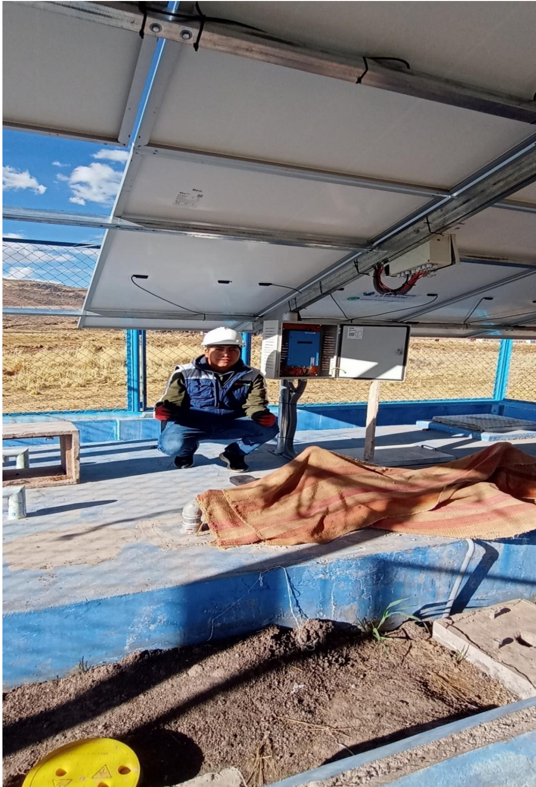
Medición de potencia de modulo solar limpio
