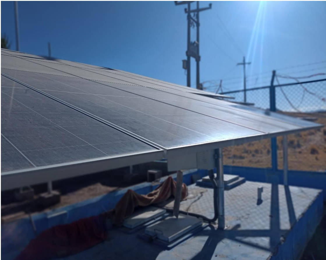
Figura 11: Modulo solar fotovoltaico con polvo Elaboración propia
