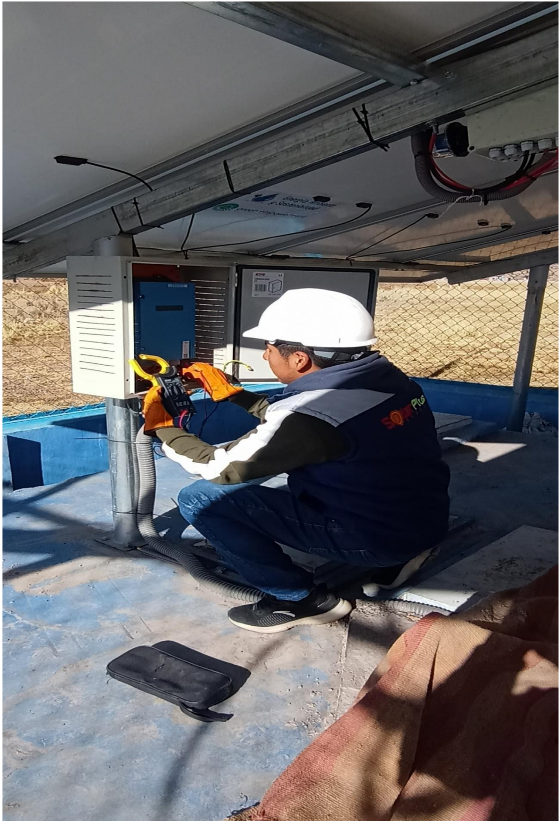
Medición de potencia con acumulación de polvo
