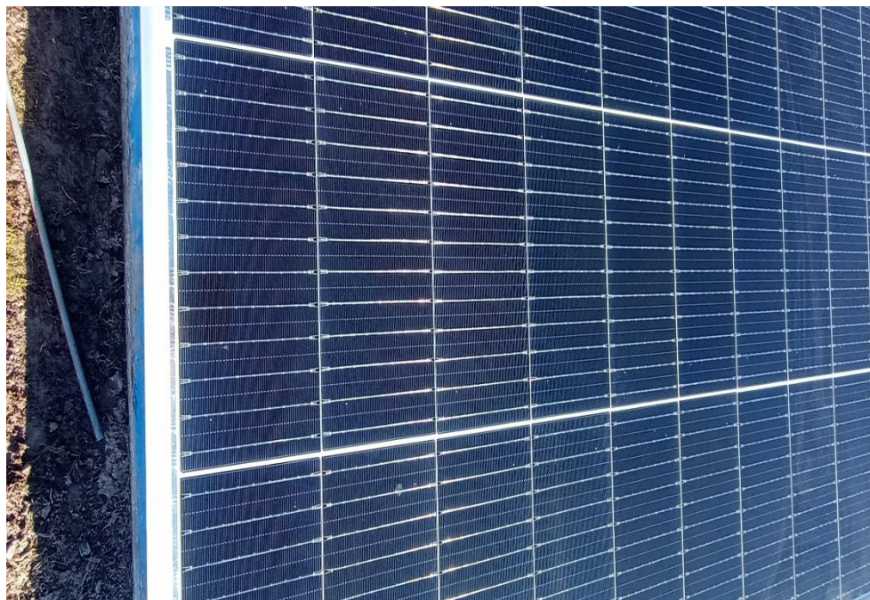
Modulo solar fotovoltaico limpio
