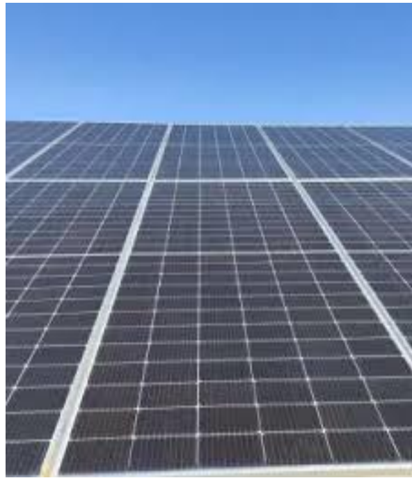
Modulo solar fotovoltaico limpio
