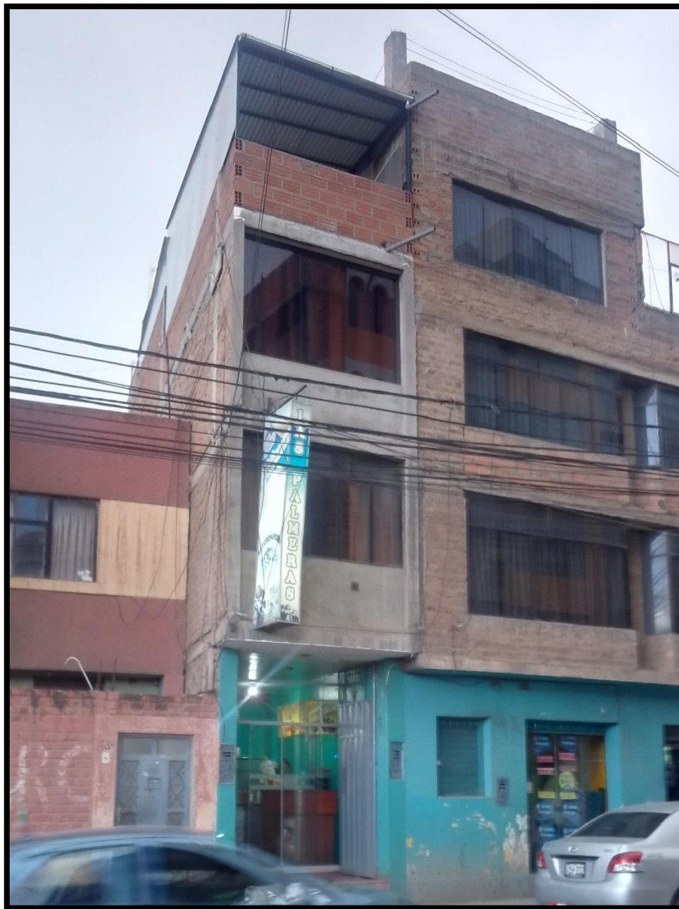
Figura 23: Edificación en el Jr. Tacna N° 828 destinada al comercio de alimentos que no cumple los requisitos de Habitabilidad
