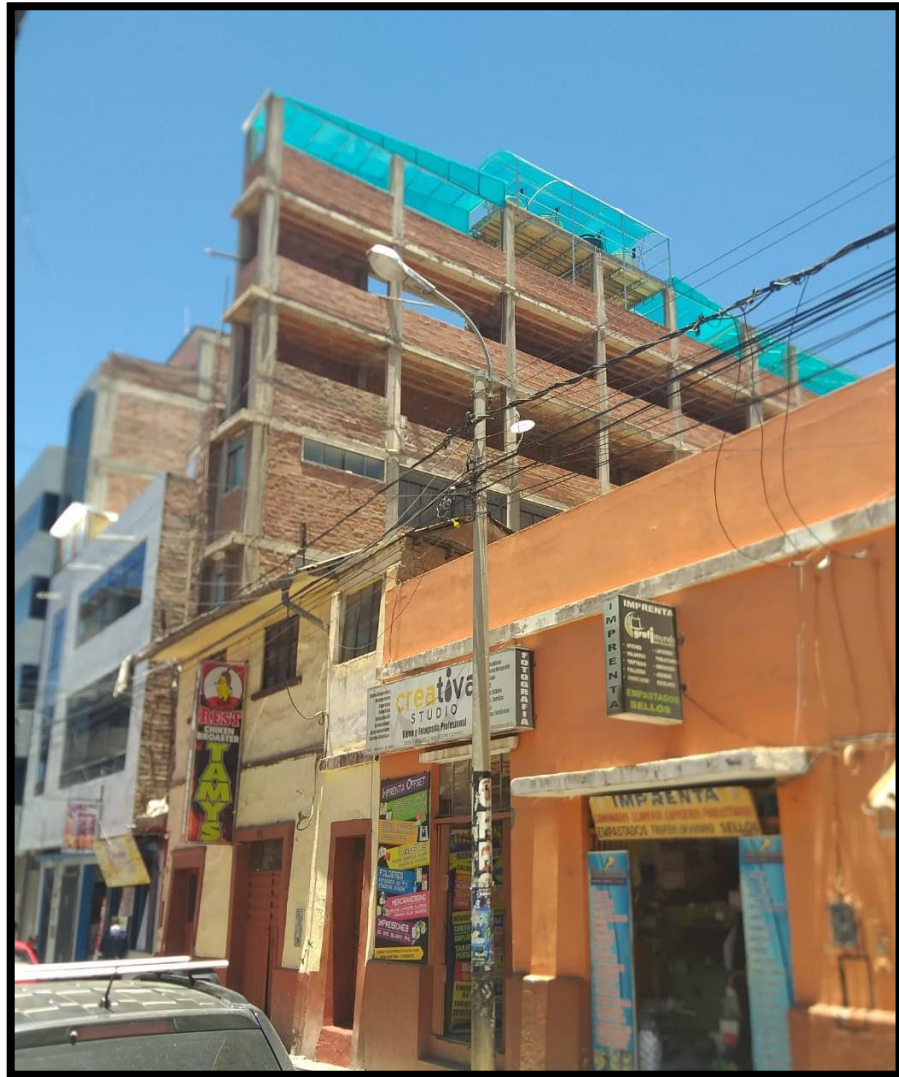
Figura 4: Vista lateral de la edificación Jr. Moquegua 442 con indicios de afectación de daño a edificaciones vecinas en caso de sismos.
