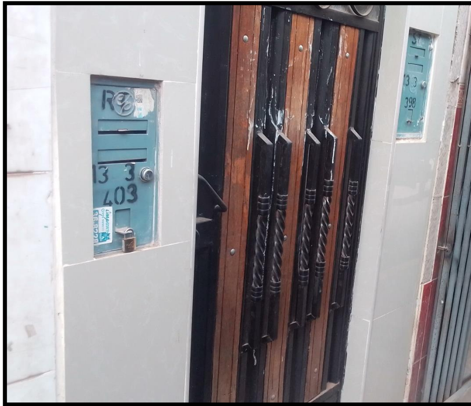
Figura 18: La edificación de la Av. Floral N° 490 presenta 2 medidores cual se indica que es una vivienda familiar sin las condiciones de Habitabilidad
