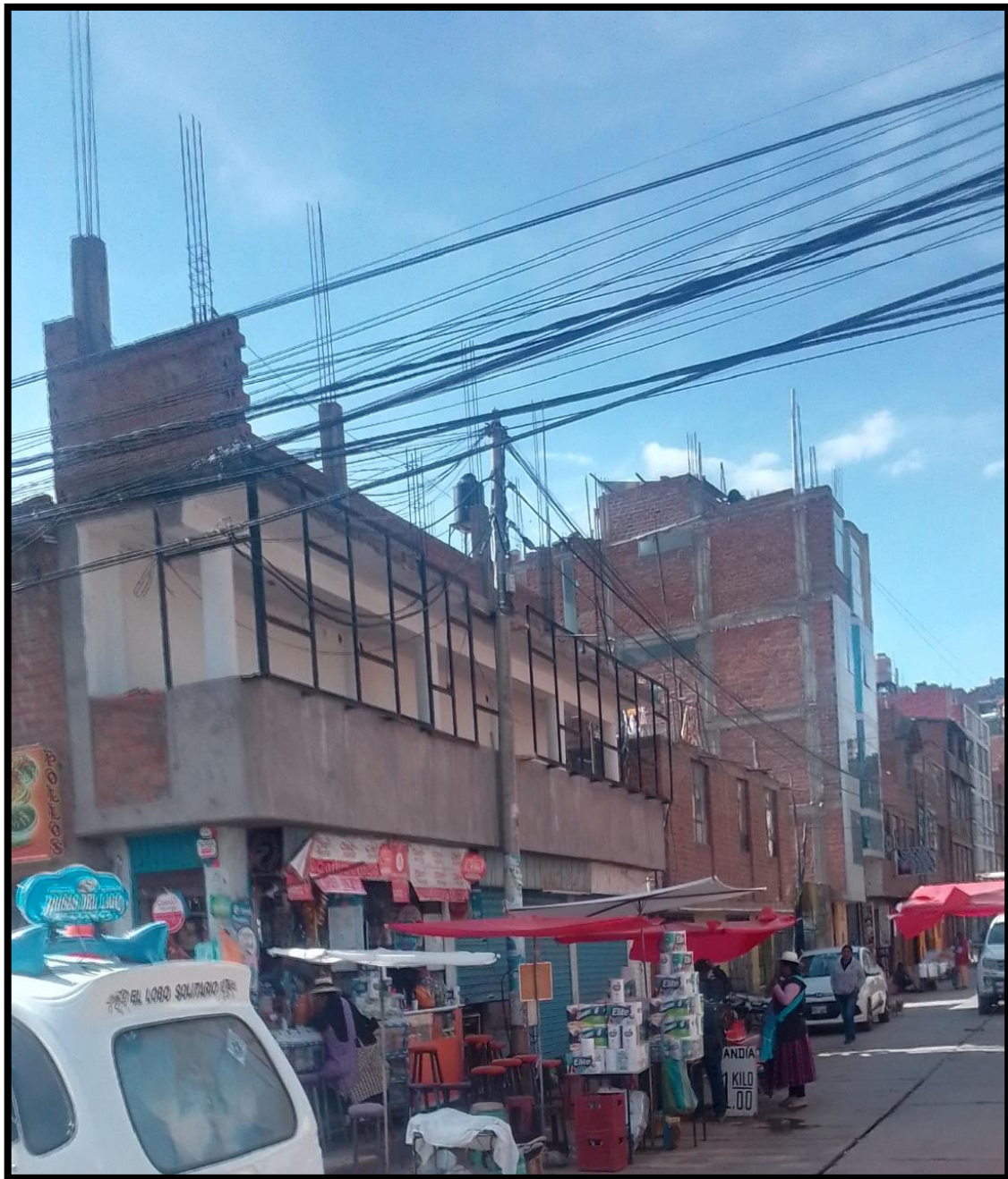
Figura 12: Vista lateral de la edificación en la esquina de los Jirones Los Incas y Andahuaylas que tiene 1m de ancho
