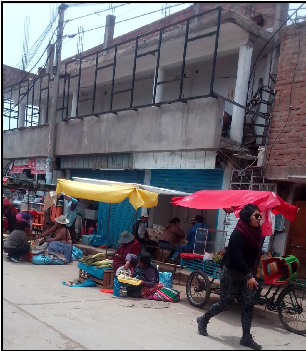
Figura 13: Vista lateral de la edificación en la esquina de los Jirones Los Incas y Andahuaylas que acredita que el segundo piso no es habitable
