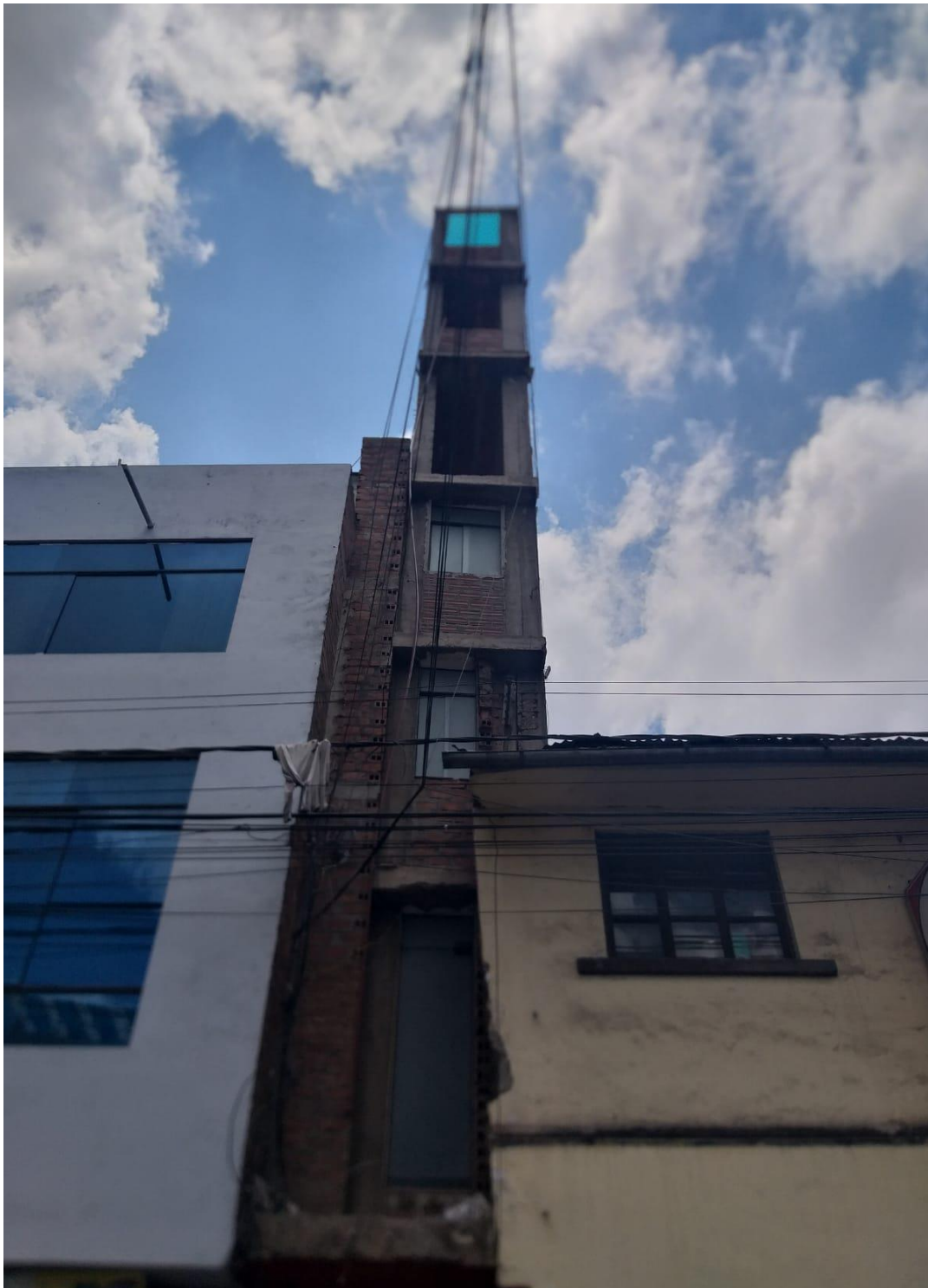
Figura 25: Foto que evidencia que la edificación en el jirón Moquegua Nro 442 invade los aires del vecino de la derecha
