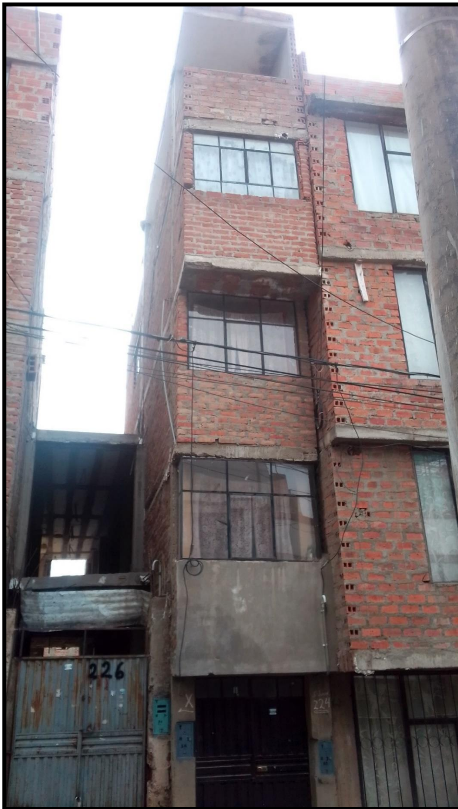
Figura 22: Vista lateral de la edificación en el Jr. Junín N° 224 que evidencia la no Habitabilidad de la edificación
