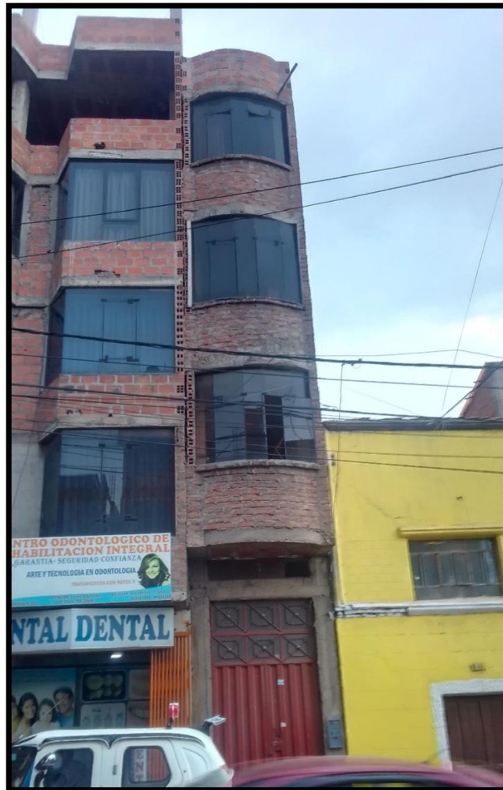
Figura 5: Vista frontal de la edificación en el Jr. Echenique N° 113 que no cumple las condiciones mínimas del RNE
