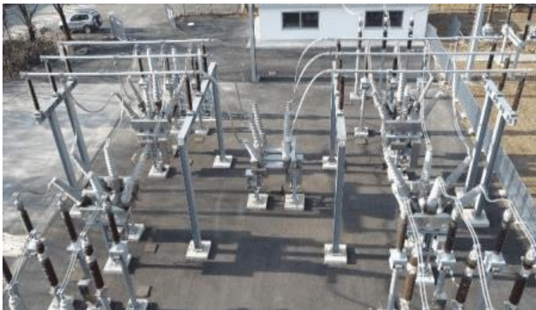
Subestación híbrida compacta
