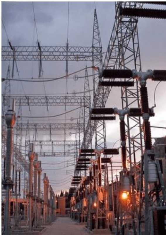
Subestación Aislada en aire (AIS)
