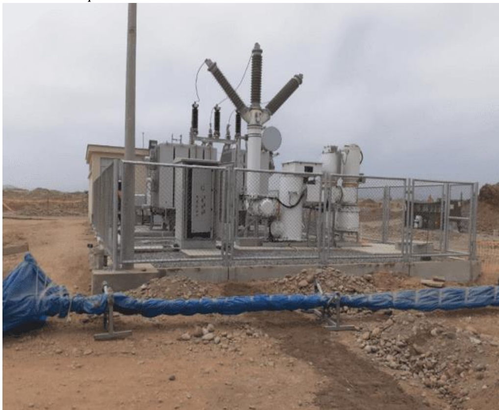
Subestación tipo GIS 60KV LAP
