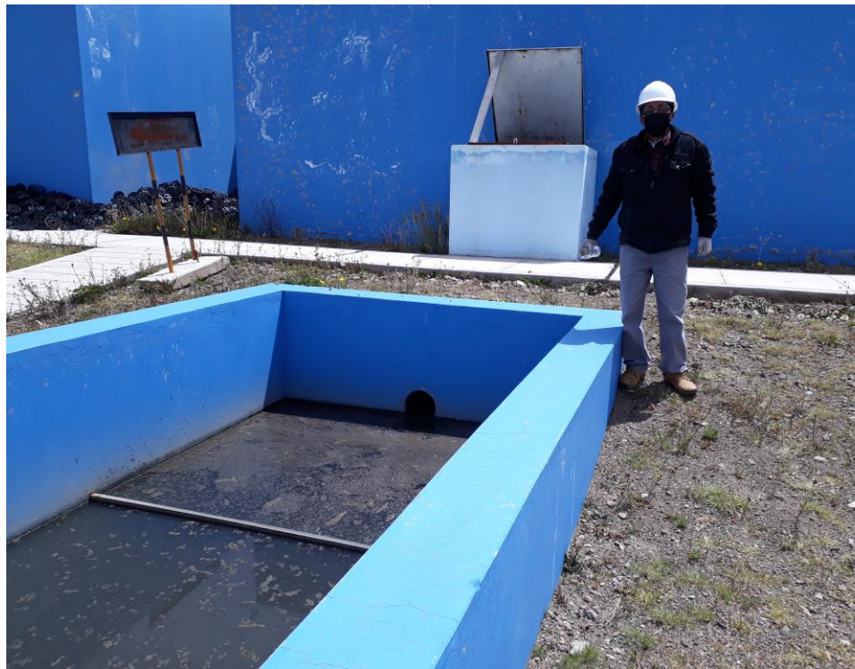
VISTA 04: Efluente del agua residual del filtro percolador
