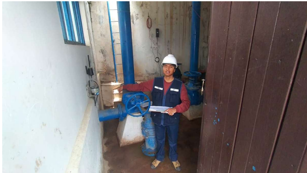
Fotografía 02. Ubicación y toma de datos del Macromedidor 05 en el Reservorio 02
