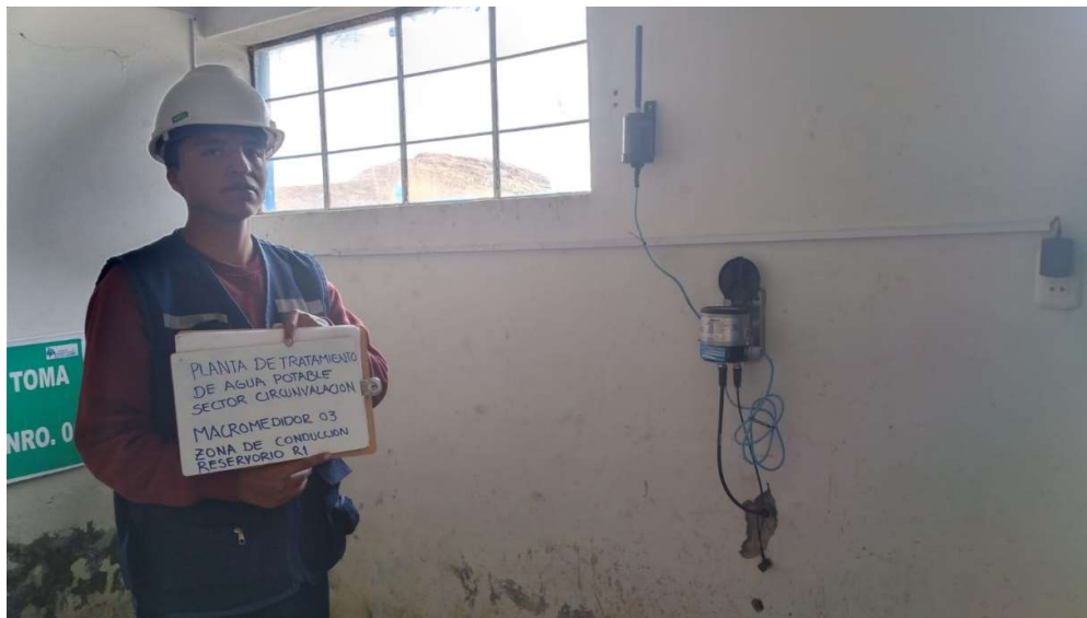
Fotografía 04. Ubicación y toma de datos del Macromedidor 03 en el Reservorio 01
