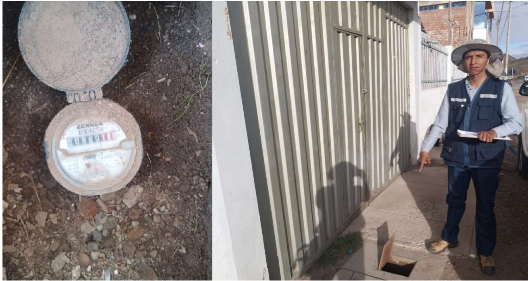
Fotografía 07. Registro de datos del 29 de enero de 2023 obtenido del micromedidor de la conexión domiciliaria con código 5119 – lectura 960.186
