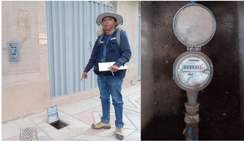
Fotografía 08. Registro de datos del 21 de enero de 2023 obtenido del micromedidor de la conexión domiciliaria con código 3554 – lectura 238.22
