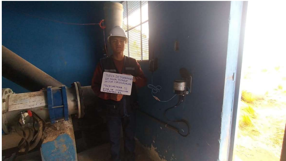
Fotografía 01. Ubicación y toma de datos del Macromedidor 01 en el Reservorio 03
