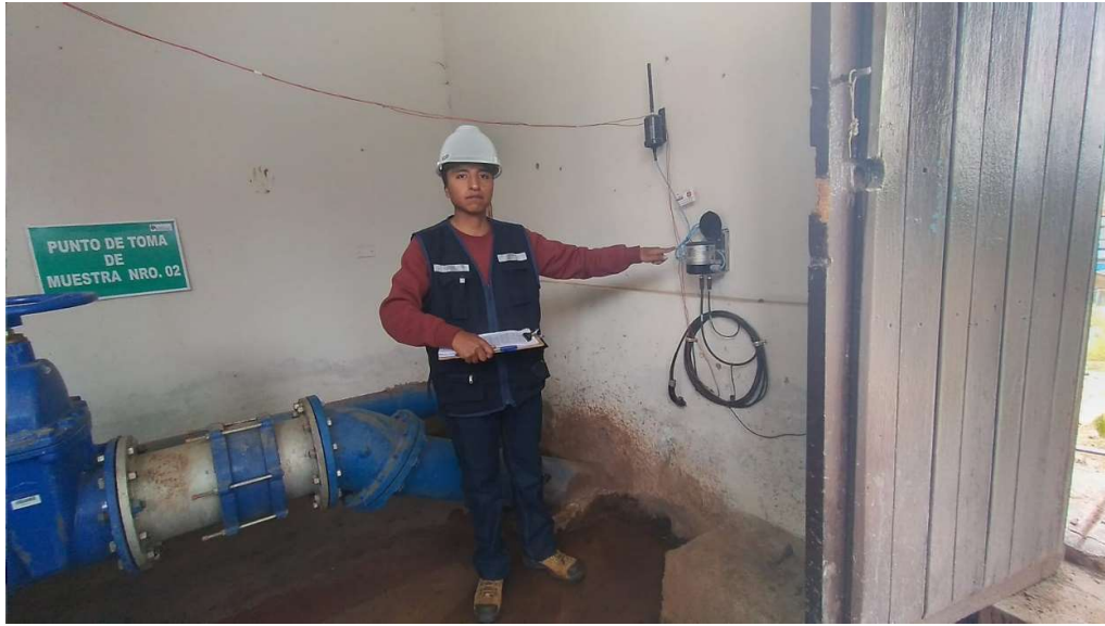
Fotografía 03. Ubicación y toma de datos del Macromedidor 02 en el Reservorio 02
