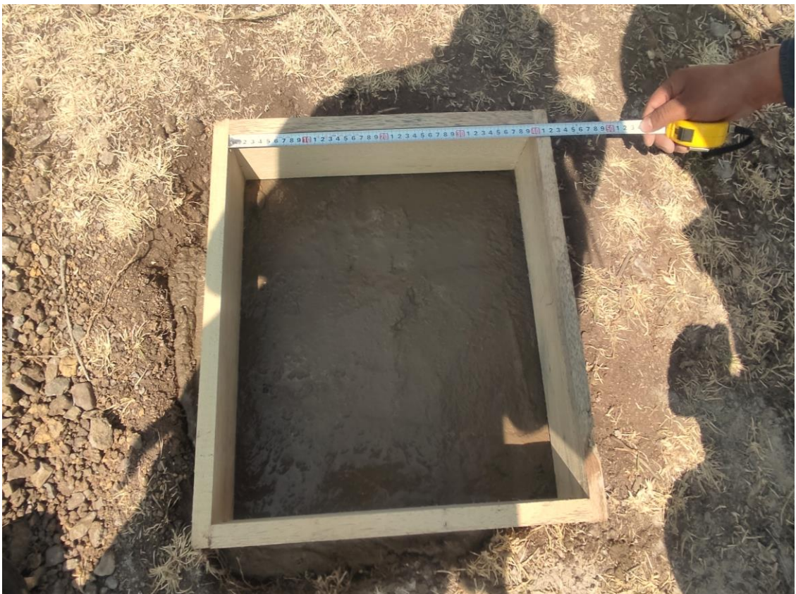
Nota: La fotografía representa la mezcla del concreto de la tercera capa para el punto PCG02. Elaboración propia.
