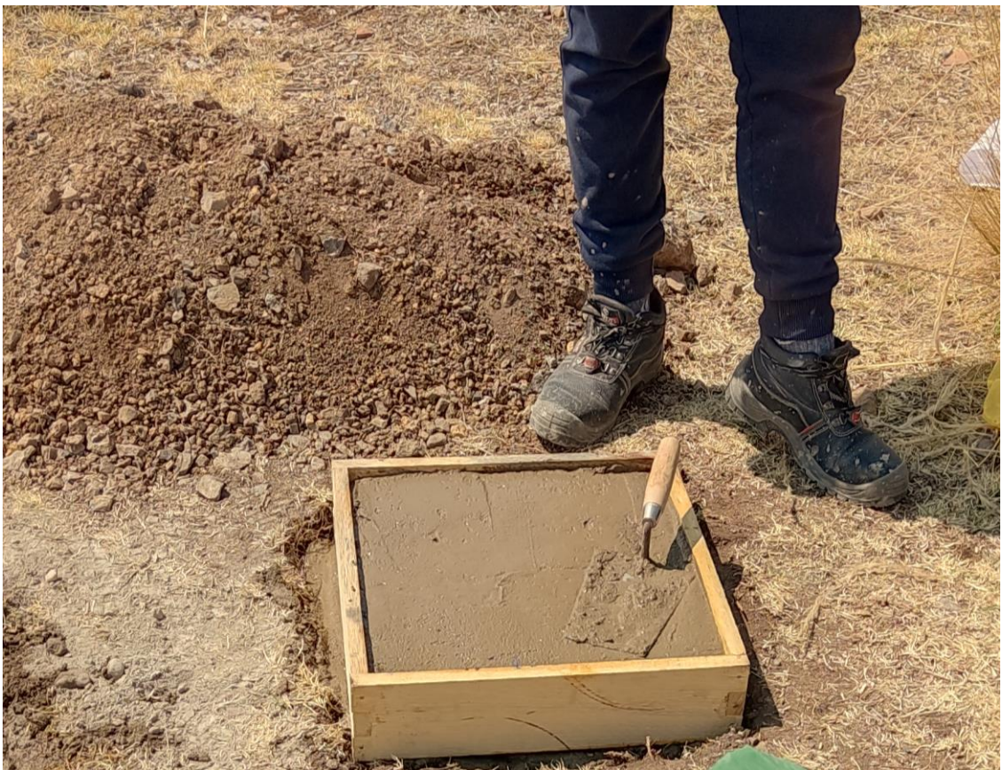
Nota: La fotografía representa la mezcla del concreto en los 10cm sobre el terreno para el punto PCG02. Elaboración propia
