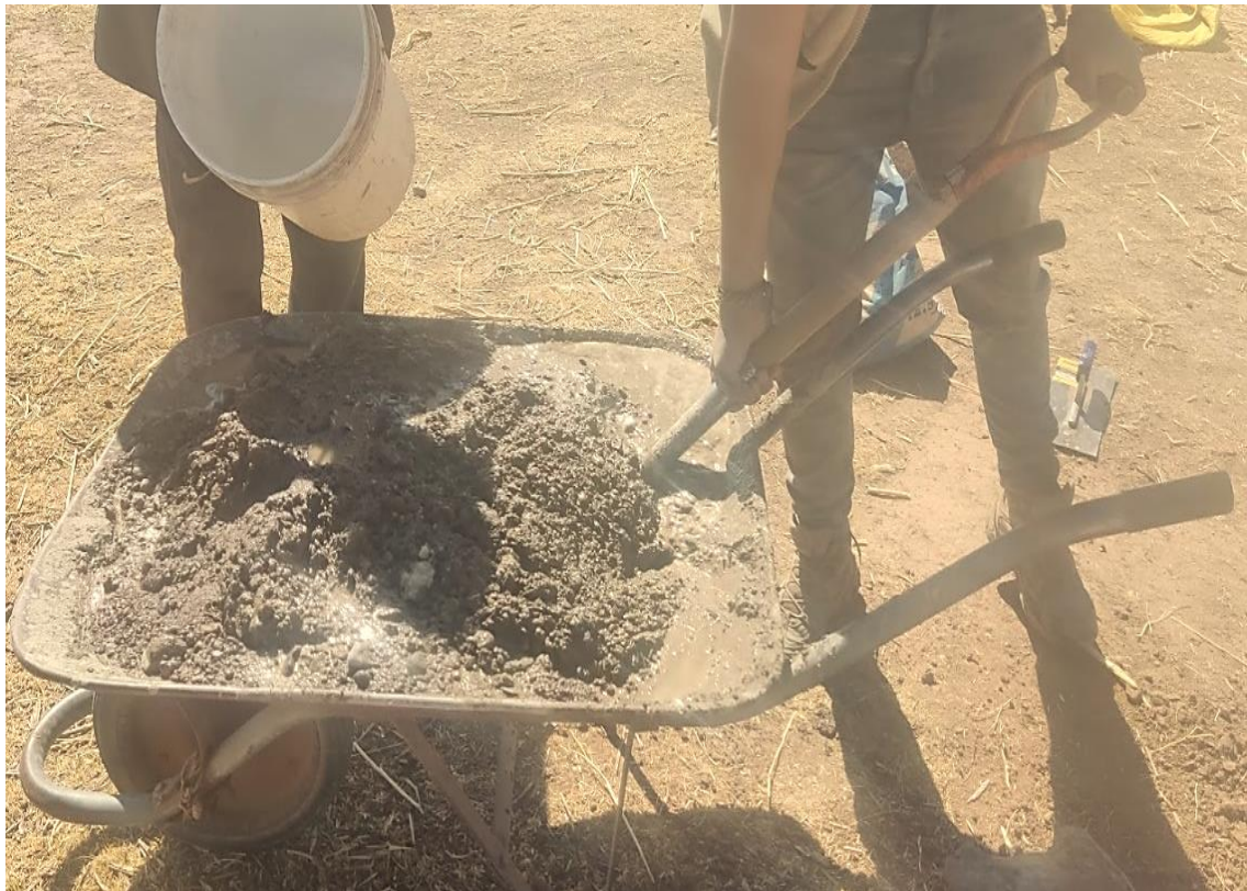
Nota: La fotografía representa la mezcla del concreto para el punto PCG02. Elaboración propia.
