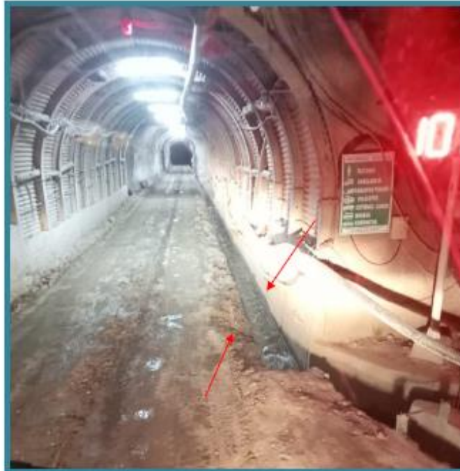
Imagen 01 y 02: Ingreso Bocamina 4300, se evidencia huellas de neumáticos que transitan cerca de las cunetas sin protección.
