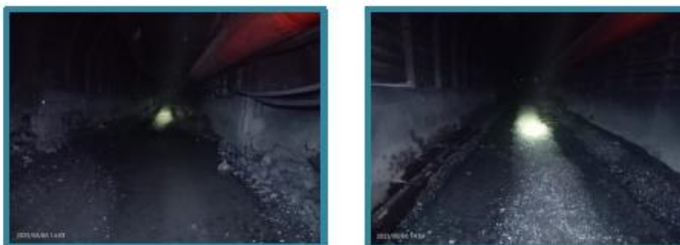
Imagen 09 y 10: Se evidencia acumulación de agua en la vía y agua escurriendo por la vía, generando desgaste y condiciones para equipo que transitan por la zona.
