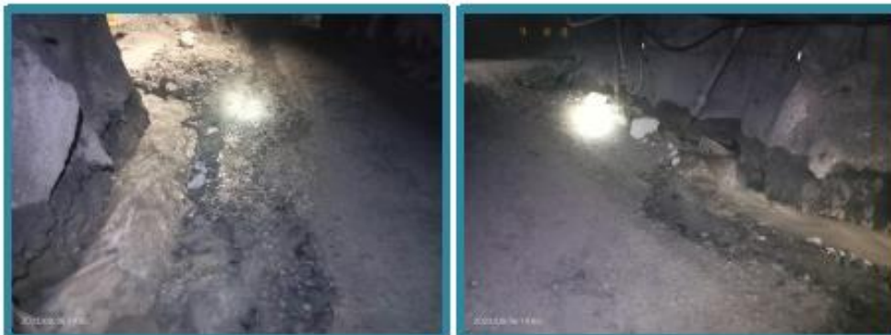
Imagen 07 y 08: Se evidencia con imágenes la fuga de agua de la cuneta por el exceso de caudal que llega a dicho punto.
