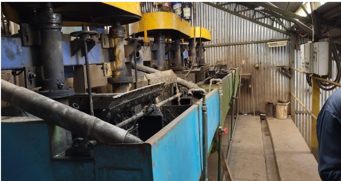
Bancada de celdas en circuito de flotación
