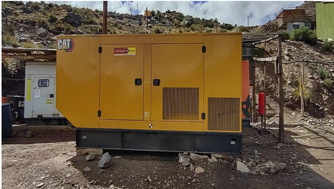
Casa fuerza- Grupo electrógeno
