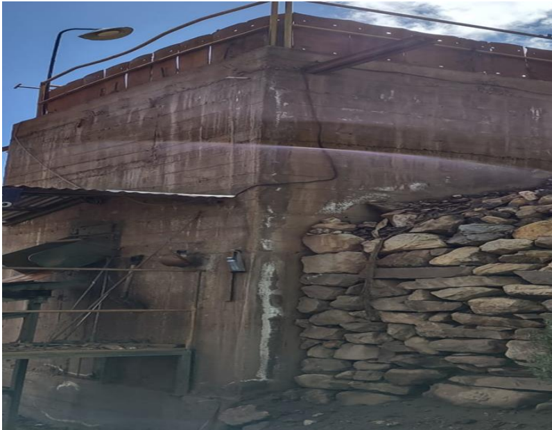
Tolva de grueso para depositar el mineral
