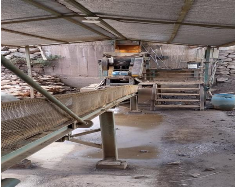
Faja transportadora para transportar el mineral chancado
