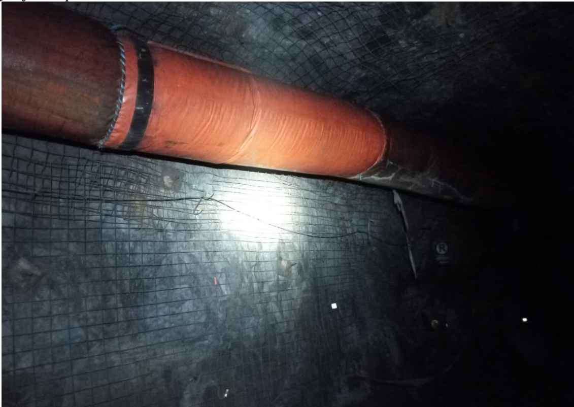
Fotografía 1. Manga de ventilación para aumentar el flujo de aire hacia los subniveles y tajos de producción
