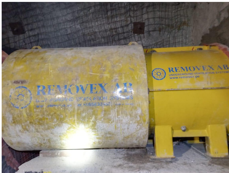
Fotografía 4. Equipo de ventilación subterránea de la marca REMOVEX AB , especializado en sistemas de ventilación para minas. Este tipo de equipo se utiliza para mejorar la circulación de aire en túneles y galerías subterráneas
