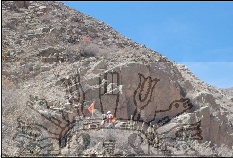
Figura N° 27, Fotografías del sector del portal de salida, Túnel de Desvío Río Asana, donde se muestran bloques de roca (riolita) y discontinuidades de gran longitud
