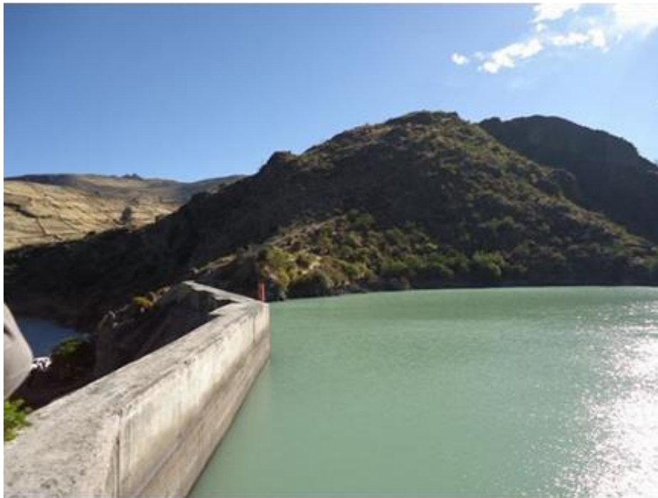
FOTOGRAFIA N° 2. Vista del estribo derecho del eje de presa Ancascocha conformado por afloramientos del grupo Tacaza
