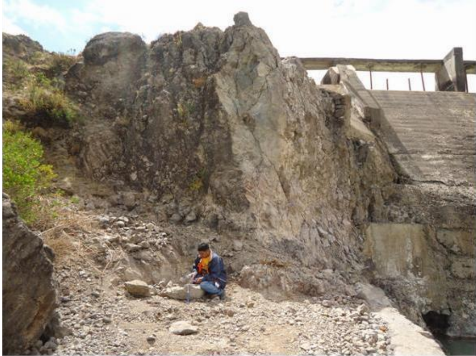
FOTOGRAFIA N° 3. Vista del Estribo derecho mostrando los aglomerados verde violáceos y el grado de fracturamiento.
