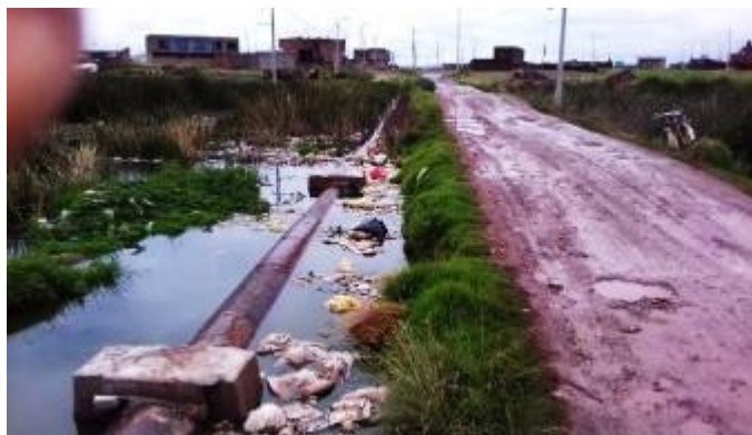
Figura 17: Tubería de conducción de aguas residuales que atraviesa el río Torococha
