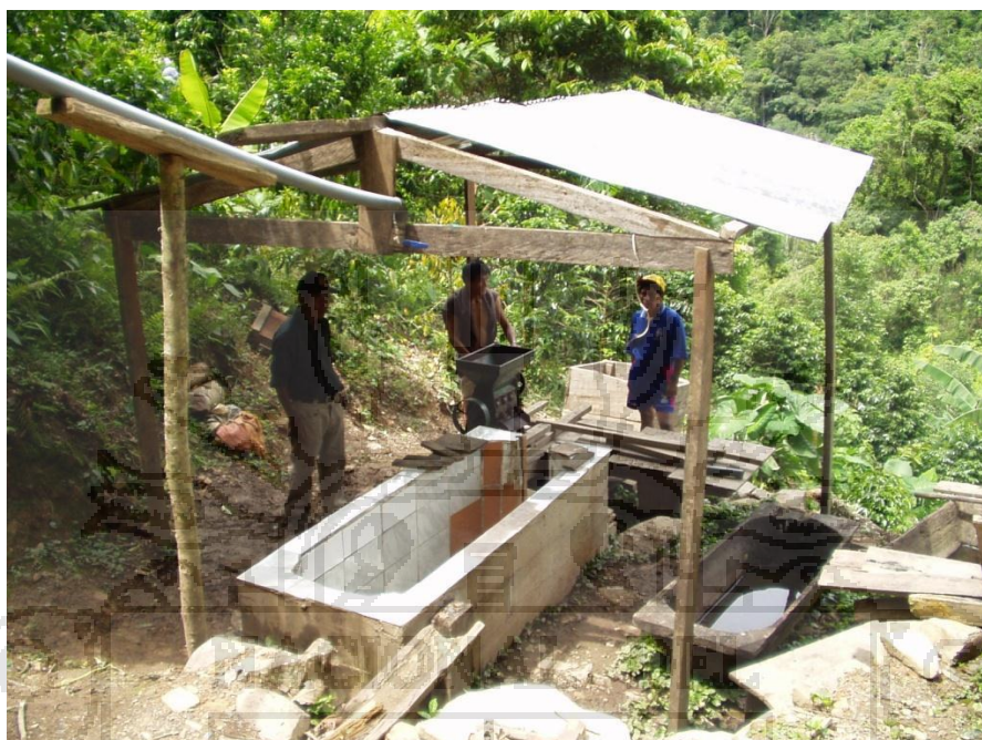
Planta de beneficio humedo del productor en su finca
