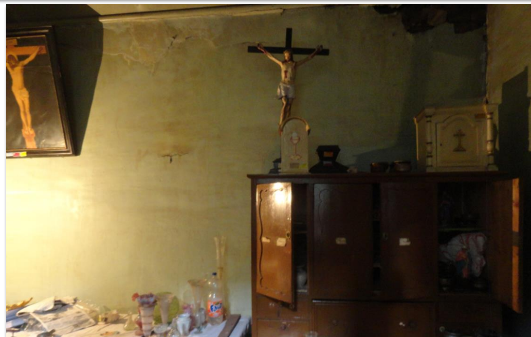
FOTO N° 10 MOVILIARIO DETERIORADO EN LA SACRISTIA
