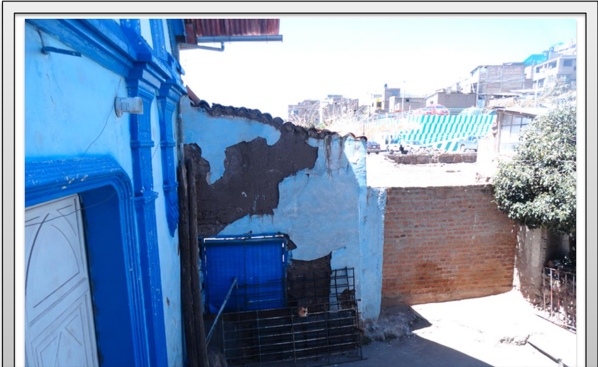
FOTO N° 11 MUROS ADYACENTES DETERIORADOS EN LA CAPILLA
